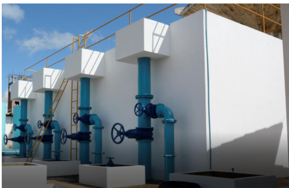
Figura 3 - Filtro de concreto
