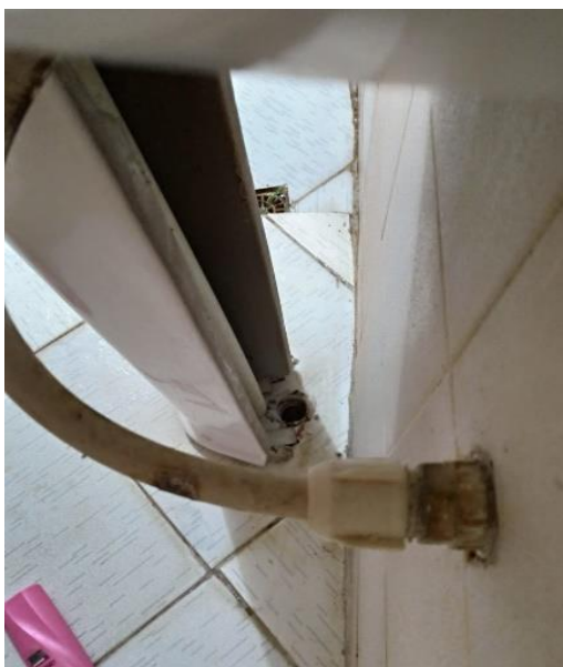
Figura 12: Ausência do sifão e erro na tubulação
