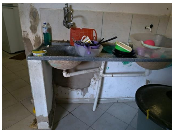
Figura 36: Ausência do sifão
