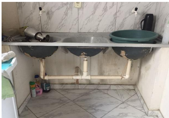
Figura 26: Ausência do sifão
