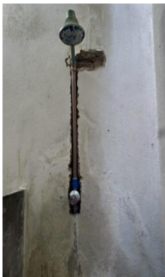
Figura 7: Rompimento da tubulação
