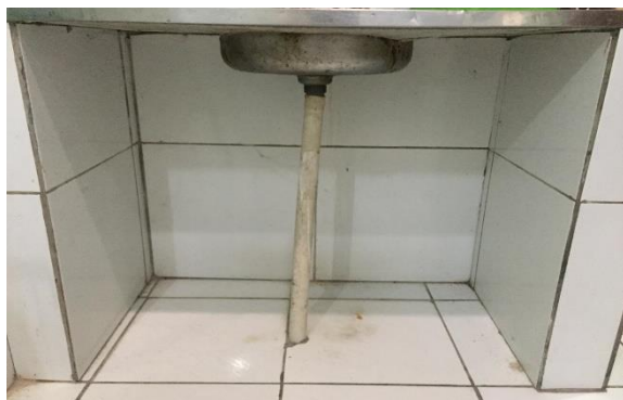
Figura 16: Ausência do sifão
