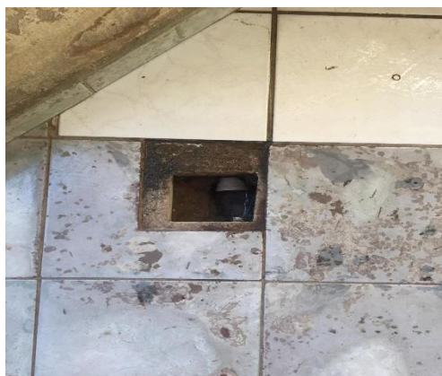
Figura 25: Caixa de gordura exposta
