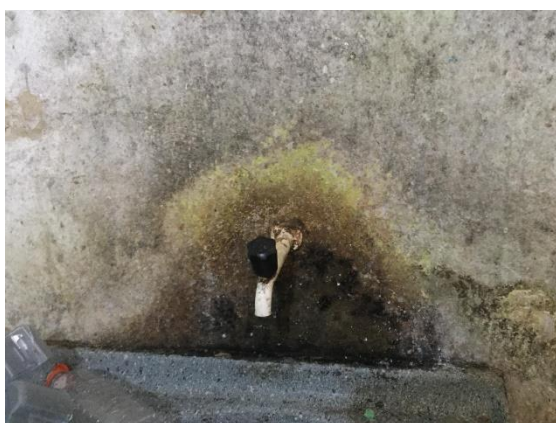
Figura 18: Vazamento na torneira
