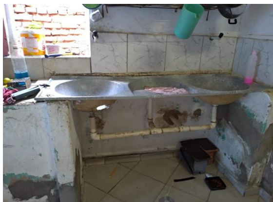
Figura 37: Ausência do sifão
