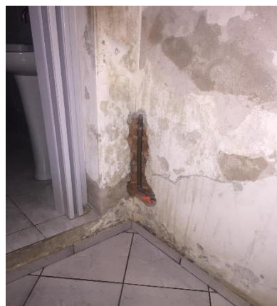
Figura 21: Rompimento na tubulação
