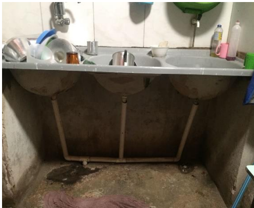
Figura 30: Ausência do sifão
