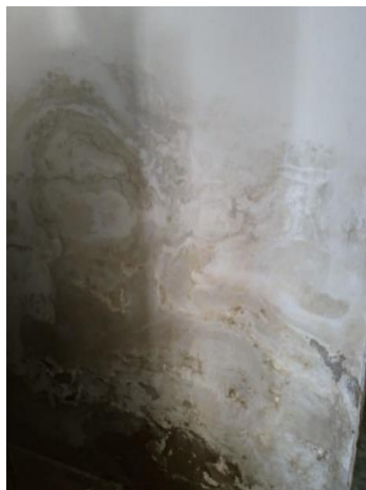
Figura 8: Umidade e bolores na parede
