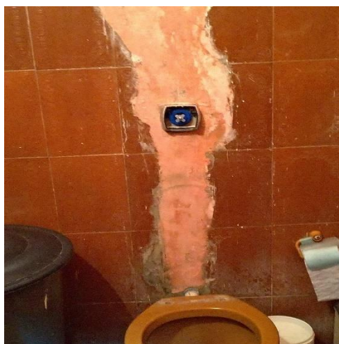
Figura 41: Rompimento da tubulação do vaso sanitário
