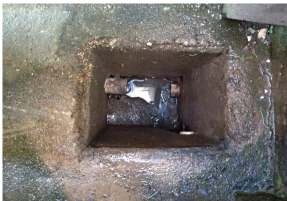
Figura 11: Caixa de gordura exposta
