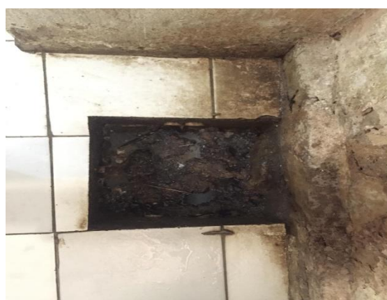
Figura 19: Caixa de gordura exposta
