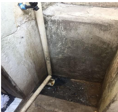
Figura 28: Caixa de gordura exposta
