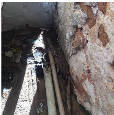
Figura 32: Caixa de gordura exposta
