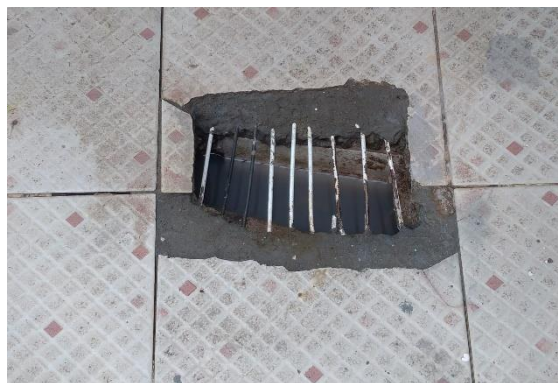
Figura 40: Caixa de gordura exposta
