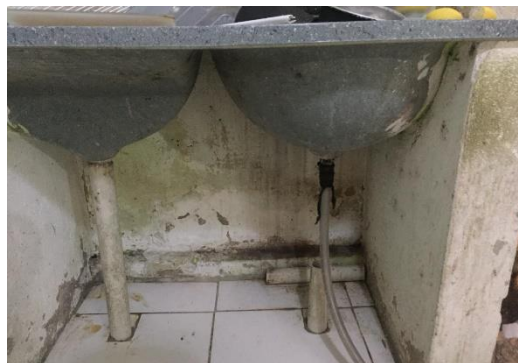
Figura 17: Ausência do sifão
