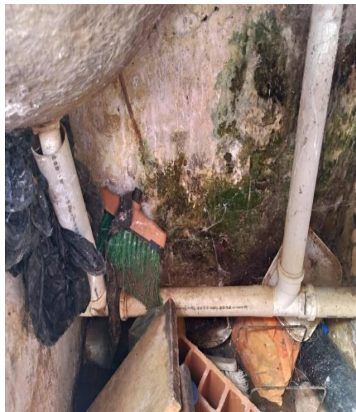
Figura 13: Ausência do sifão
