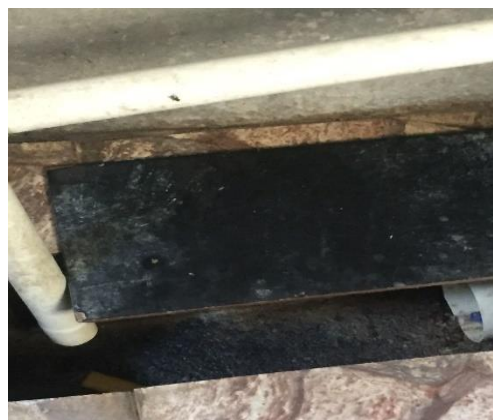
Figura 34: Caixa de gordura exposta
