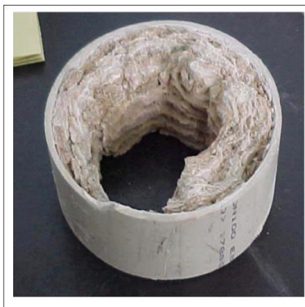
Figura 4: Depósito de material composto de bicarbonato em tubos de águas pluviais
