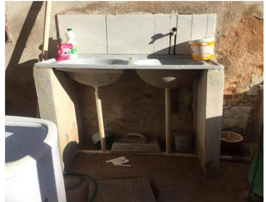
Figura 31: Ausência do sifão e tubulação exposta
