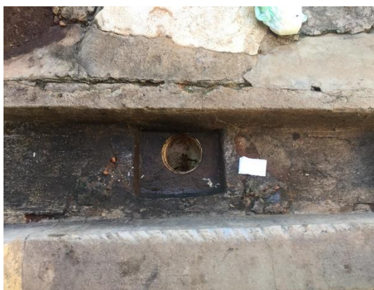
Figura 22: Tubulação de esgoto exposta
