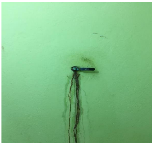
Figura 23: Vazamento do registro geral
