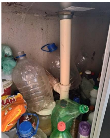
Figura 9: Ausência do sifão
