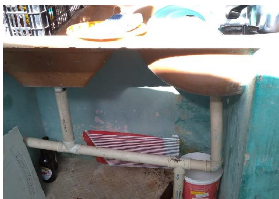
Figura 39: Ausência do sifão
