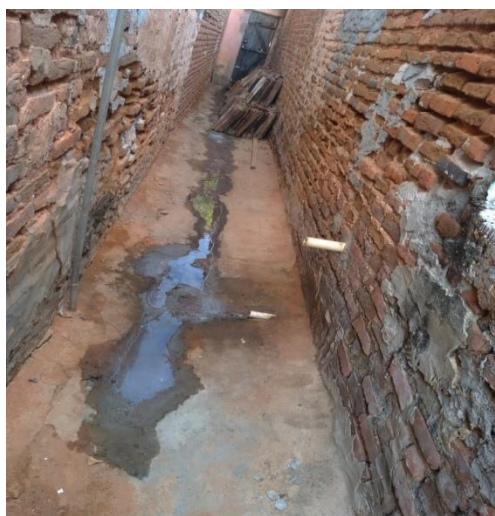
Figura 38: Falta de tubulação do esgoto
