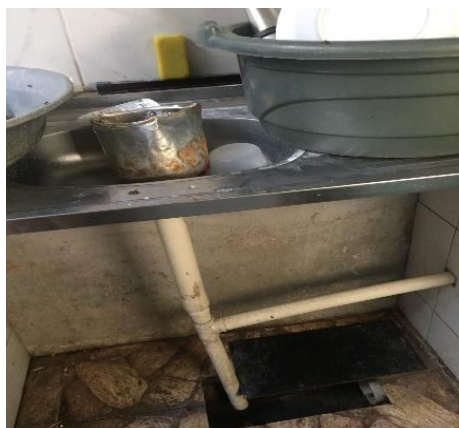
Figura 33: Ausência do sifão
