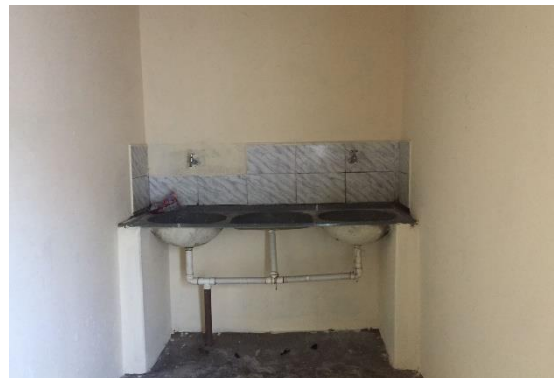
Figura 27: Ausência do sifão
