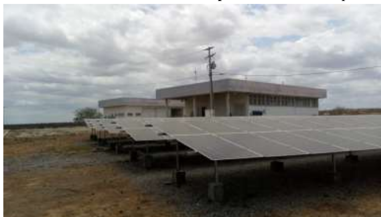
Figura 3 - Microusina solar de 62,7 kWp da UFERSA Campus Angicos
