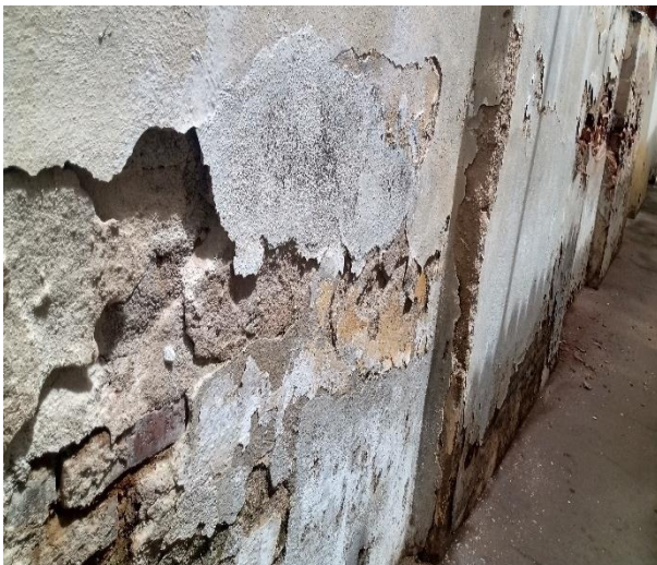
Figura 32: Degradação do muro lateral da área infantil.
