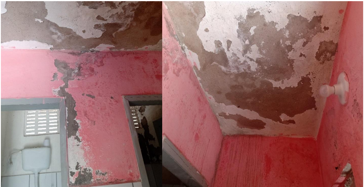
Figura 29: Destacamento do revestimento e infiltrações no banheiro feminino.
