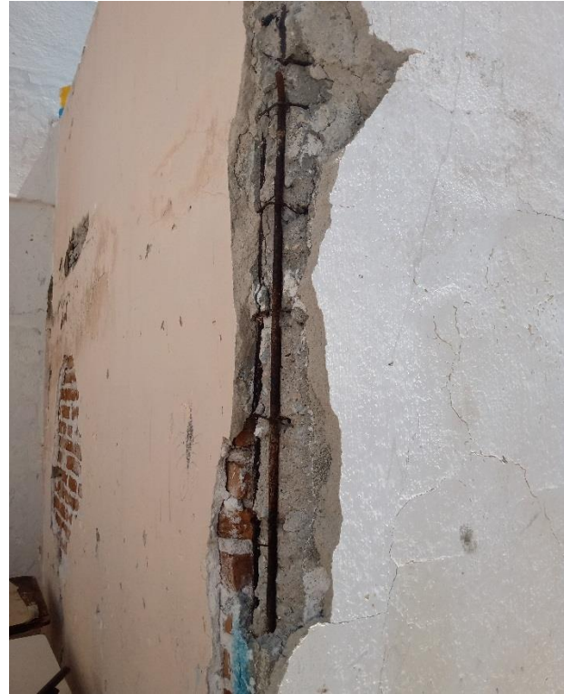
Figura 23: Oxidação total das armaduras de aço.
