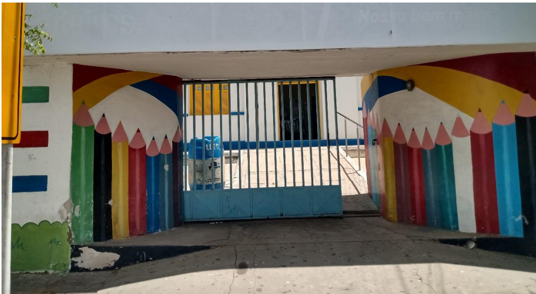
Figura 13: Fachada frontal da instituição com destacamento do revestimento.
