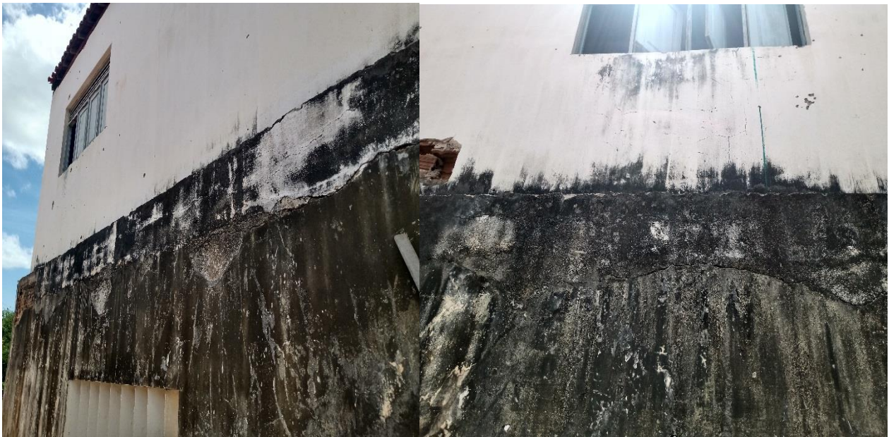
Figura 43: Sujidades e mofo no revestimento da fachada lateral exterior.
