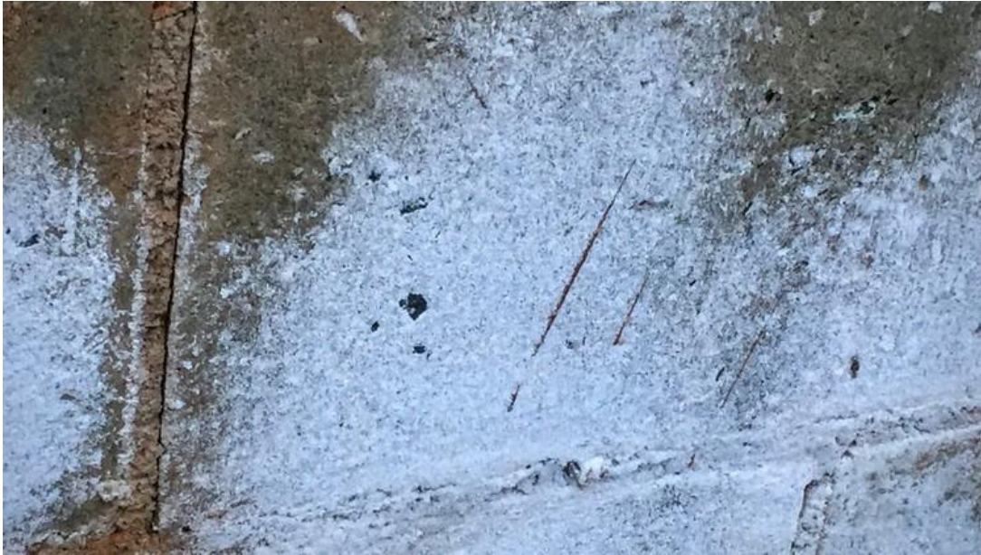
Figura 5: Revestimento com problemas de eflorescência.
