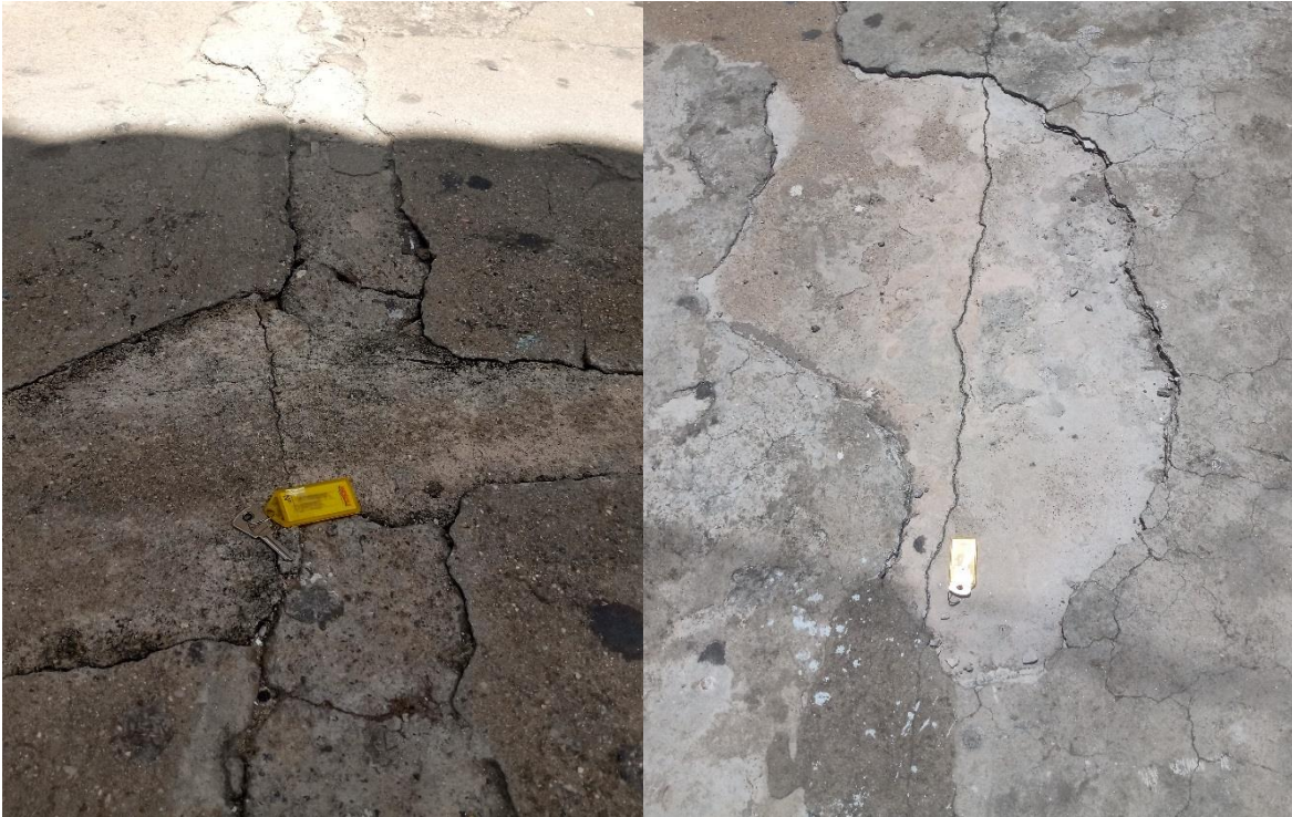
Figura 16: Degradação causada por fissuras e destacamento no contrapiso de entrada.
