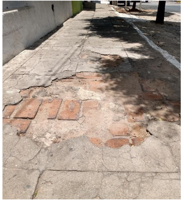
Figura 15: Degradação da calçada.
