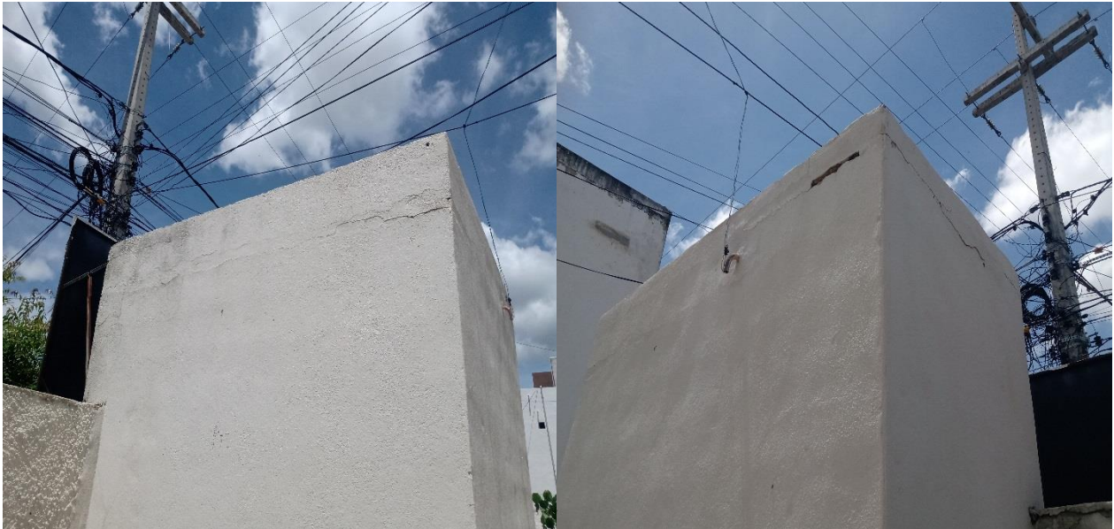
Figura 17: Fissuras horizontais paralelo ao comprimento da laje de cobertura da guarita.
