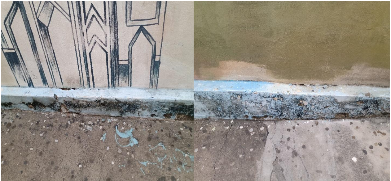
Figura 21: Manchas e mofo causado por infiltração na parede da secretaria.
