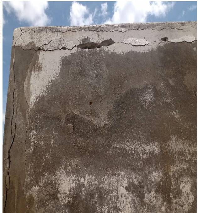
Figura 35: Fissuras devido a movimentação térmica do banheiro da área infantil.
