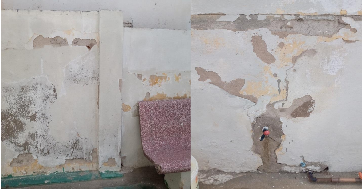
Figura 18: Degradação do revestimento do muro da instituição.
