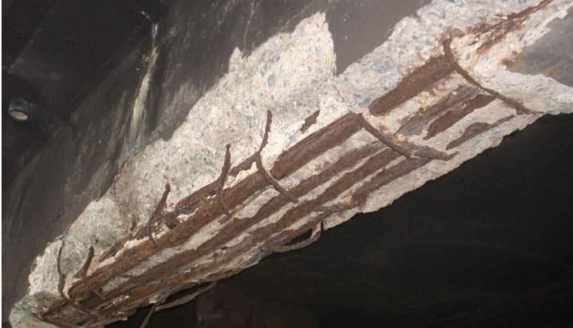
Figura 10: Corrosão das armaduras de aço do concreto armado.
