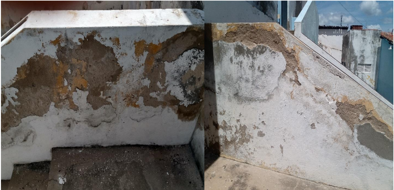
Figura 30: Deterioração da segunda escadaria do pátio posterior da instituição.
