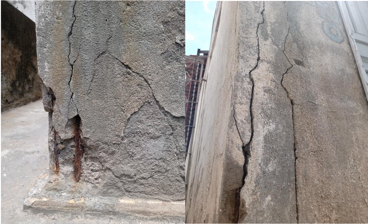
Figura 36: Corrosão das armaduras de aço e destacamento da camada de recobrimento do aço dos banheiros da área infantil.
