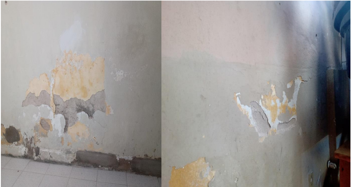
Figura 25: Destacamento no revestimento da parede da cozinha da instituição.
