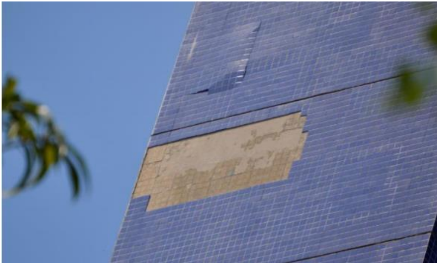
Figura 7: Destacamento do revestimento cerâmico.
