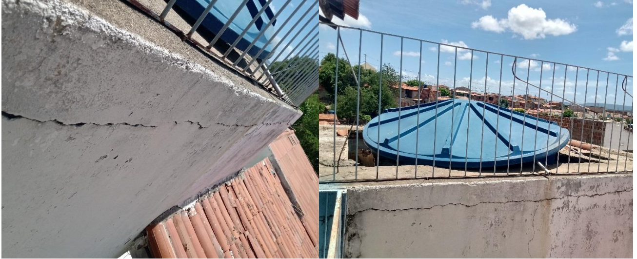
Figura 40: Avariação da caixa d'água do banheiro central.
