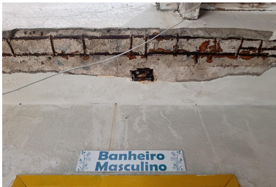
Figura 27: Destacamento e oxidação da armadura de aço da estrutura dos banheiros.
