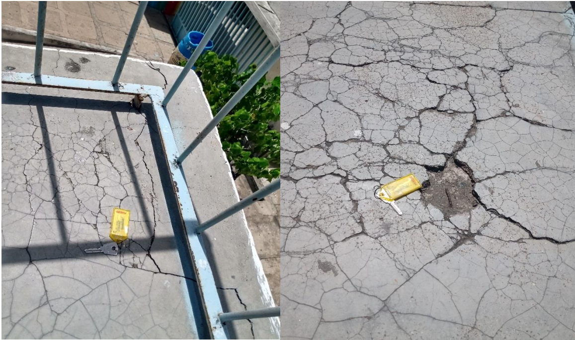
Figura 38: Degradação da laje do pavimento superior.
