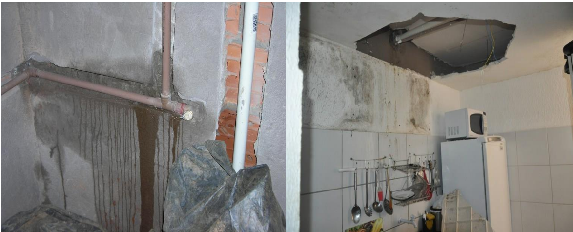
Figura 8: Infiltrações causado por rupturas em tubulações de água fria.
