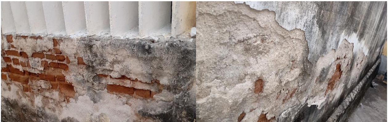
Figura 42: Degradação do revestimento e alvenarias da fachada lateral exterior.
