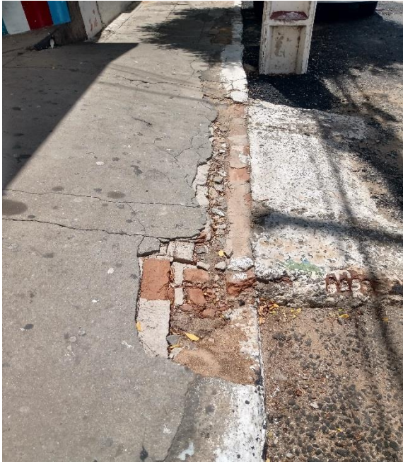
Figura 14: Degradação da rampa de entrada.
