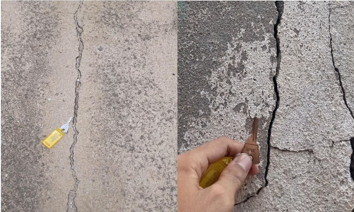
Figura 31: Fissuras e rachaduras no contrapiso do pátio da área infantil
