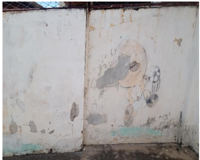
Figura 33: Degradação do muro posterior da área infantil.
