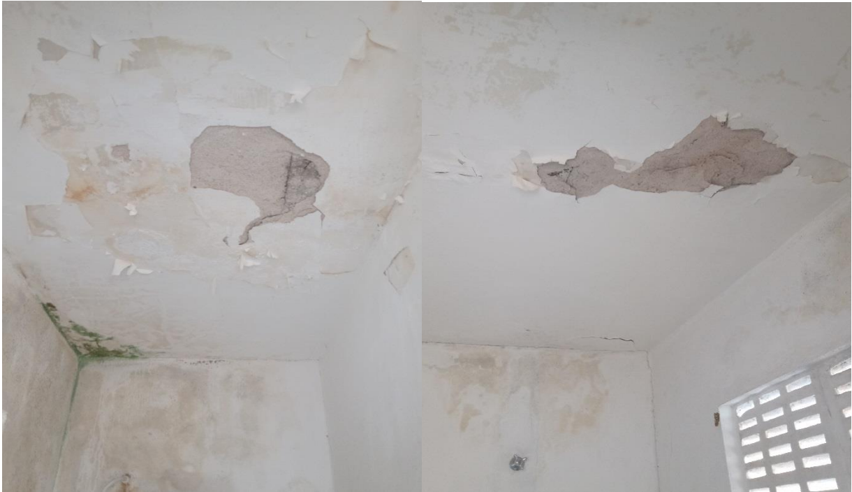
Figura 37: Deterioração e infiltrações no interior dos banheiros masculino e feminino.
