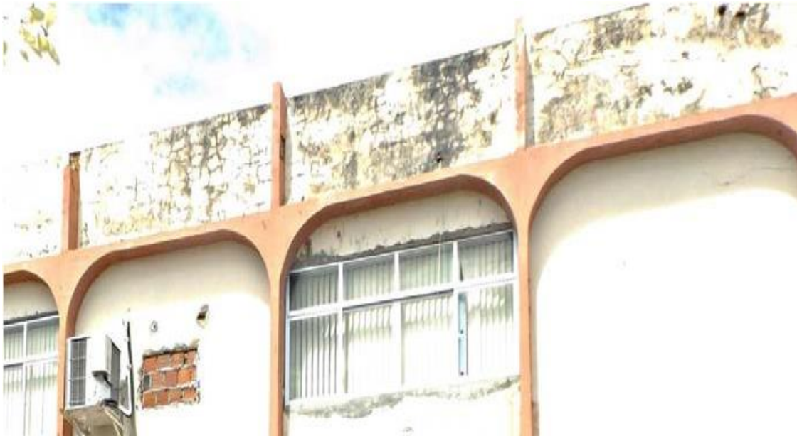
Figura 6: Manchas e bolor nas fachadas dos revestimentos.
