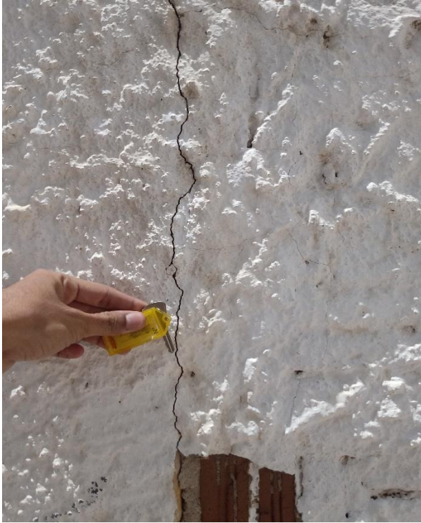
Figura 19: Trincas devido à falta de aderência entre a alvenaria e a estrutura de concreto.
