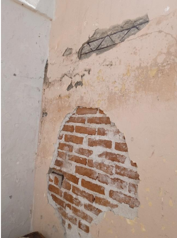
Figura 22: Destacamento do revestimento e exposição total da alvenaria nas escadarias.
