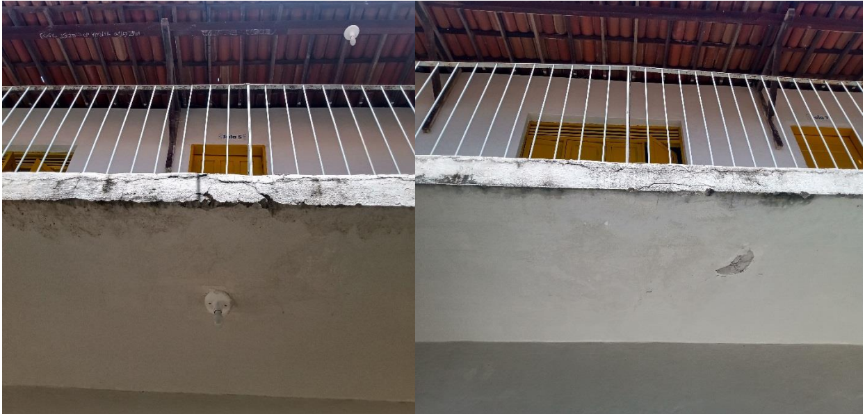
Figuras 39: Sujidades e infiltrações na laje do pavimento superior.
