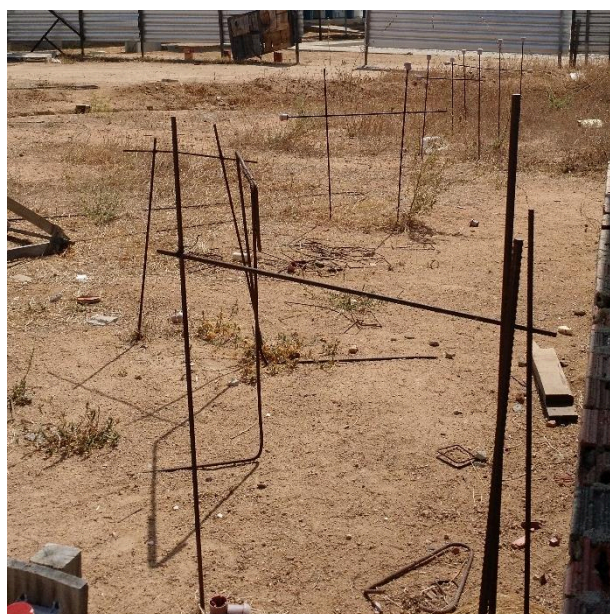
Figura 16: Pontas de vergalhões desprotegidas (2ª Visita)
