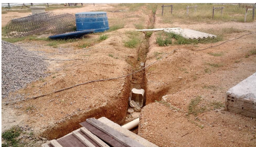
Figura 18: Abertura no chão no meio do terreno
