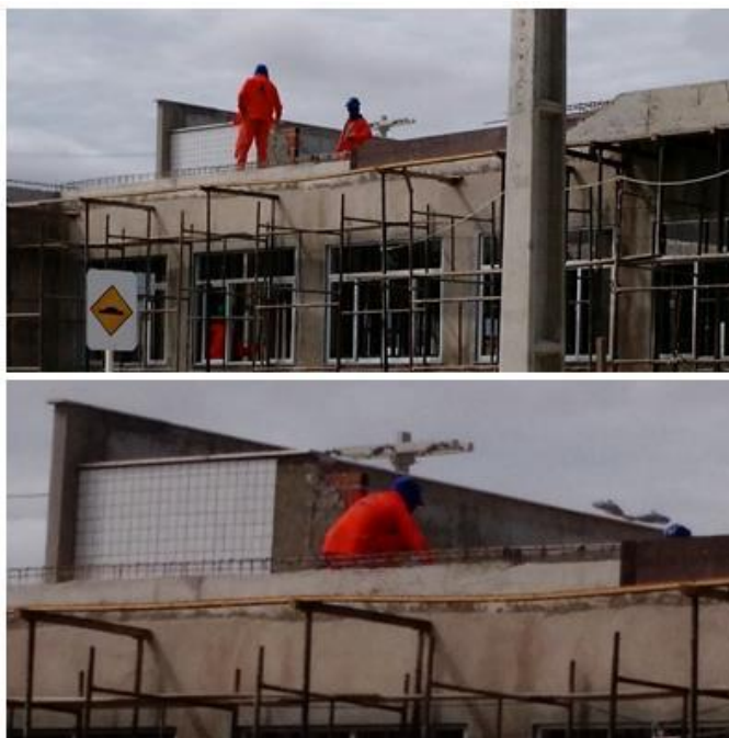
Figura 19: Falta de proteção na periferia da edificação
