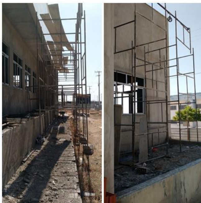
Figura 22: estrutura sobre base irregular e desencaixada
