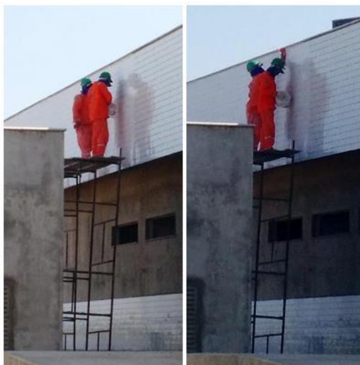
Figura 23: Falta do Cinto de segurança
