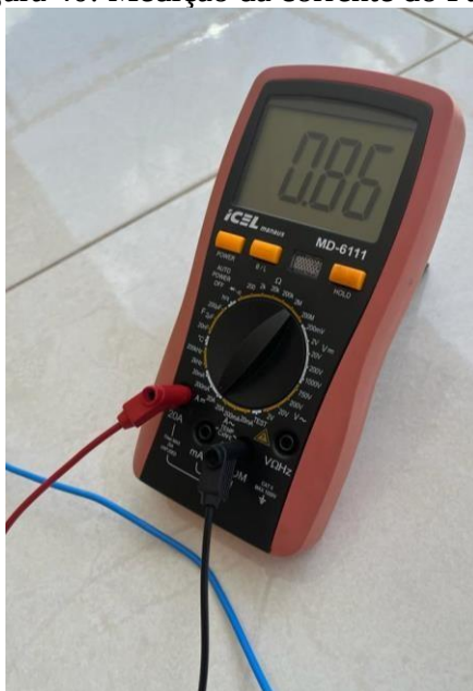
Figura 40: Medição da corrente do Painei
