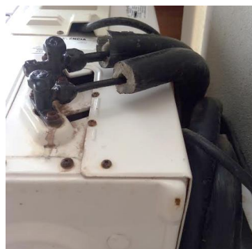
Figura 61 - Isolação térmica do sistema de climatização
