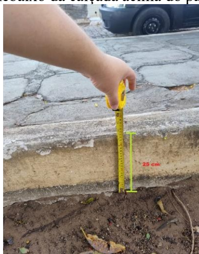
Figura 26 – Rebaixo da calçada acima do padrão normativo
