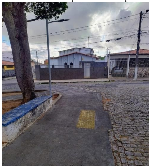
Figura 23 – Rebaixo de calçadas fora do padrão normativo
