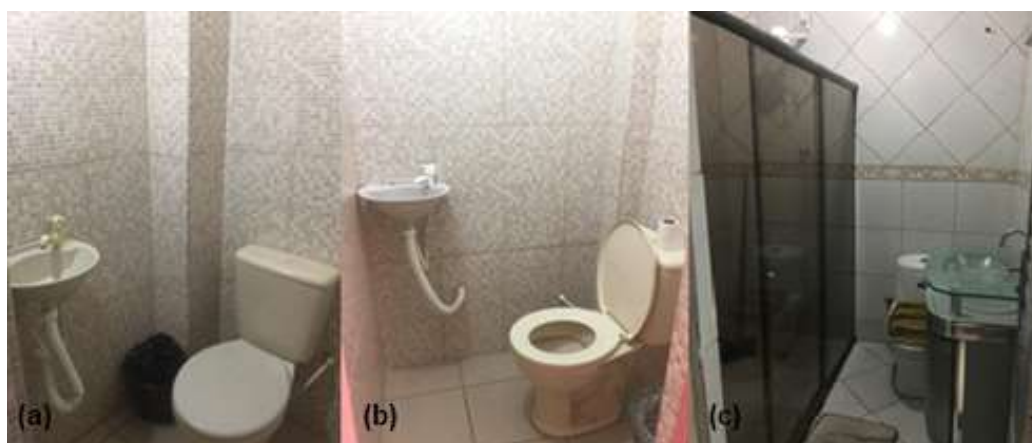
Figura 35: Sanitários: (a) e (b) atendimento salas de aula e administrativo, (c) atendimento creche
