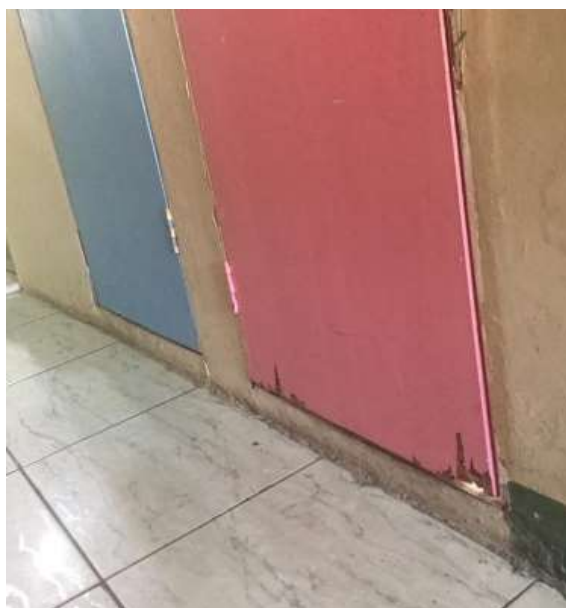
Figura 36: Desnível dos sanitários
