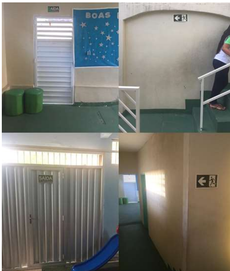
Figura 28: Sinalização de emergência
