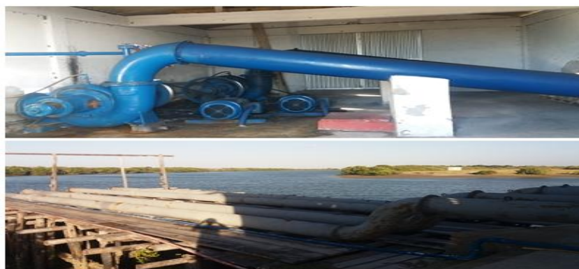
Figura 8: Bomba de captação da água
