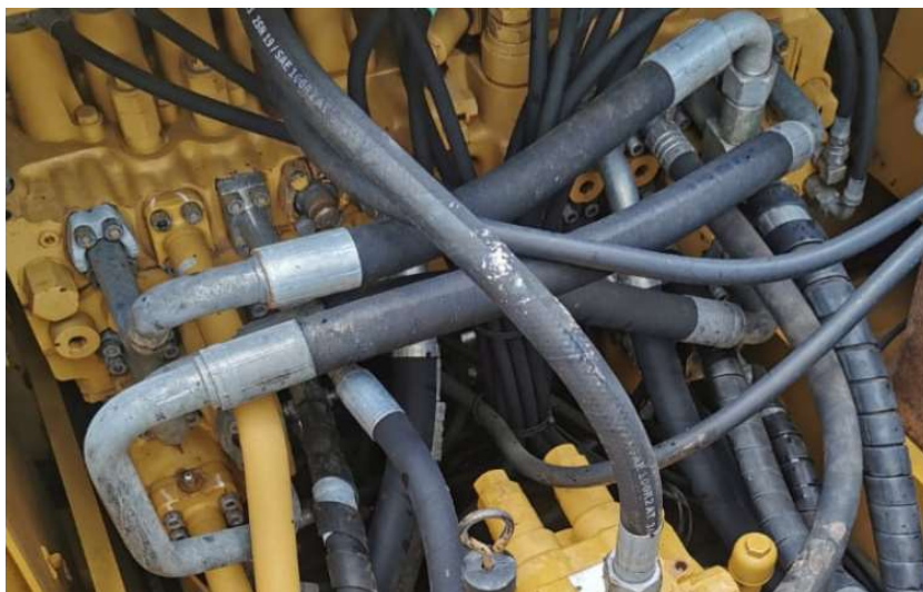
Figura 12: Equipamento com mangueiras substituídas
