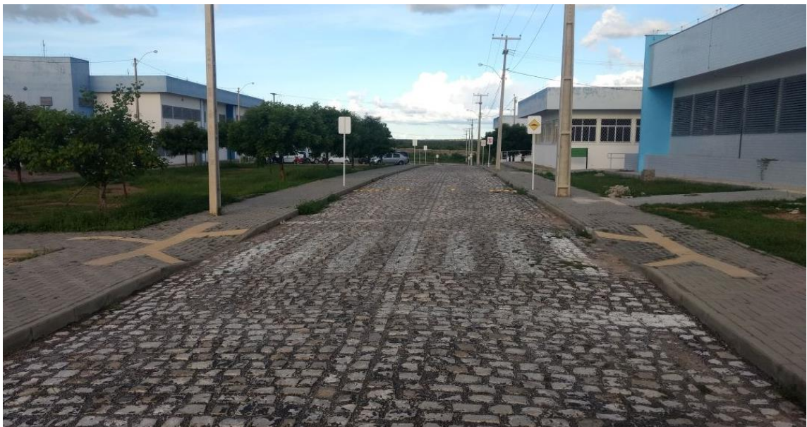
Figura 17 – Exemplo de passarela em não conformidade
