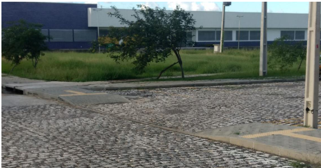
Figura 18 – Exemplo de passarela em não conformidade
