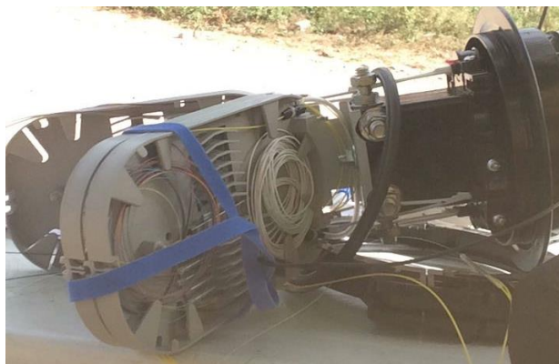
Figura 35 – Caixa de Distribuição Óptica (CDO).
