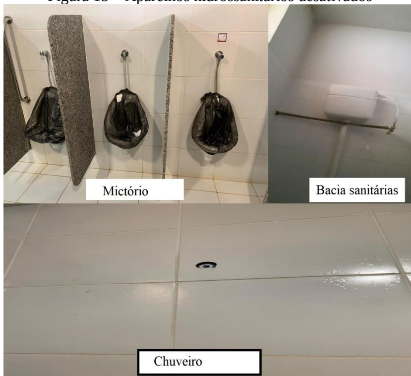
Figura 15 – Aparelhos hidrossanitários desativados
