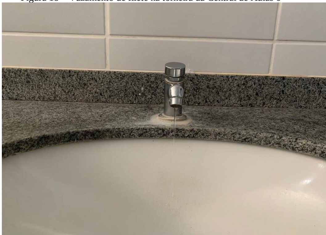
Figura 18 – Vazamento de filete na torneira da Central de Aulas 6
