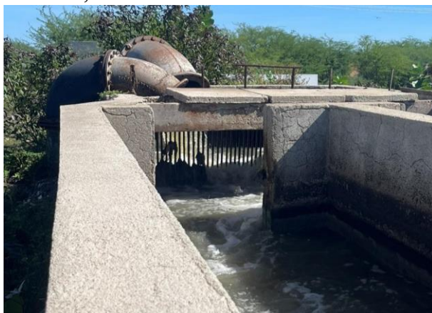
Figura 5 – Tratamento preliminar por gradeamento na Estação de Tratamento de Esgoto Cajazeiras, inseridas no município de Mossoró, Rio Grande do Norte
