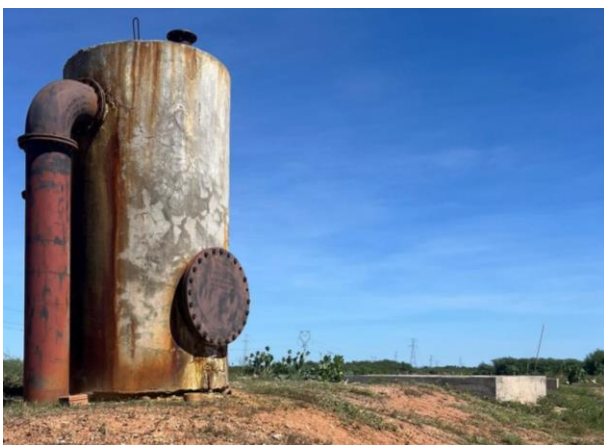
Figura 9 – Tanque de amortecimento unilateral (TAU) na Estação de Tratamento de Esgoto Passagem de Pedras/Rincão, inserida no município de Mossoró, Rio Grande do Norte
