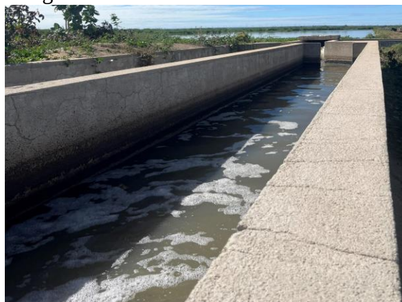
Figura 6 – Tratamento preliminar por caixa de areia na Estação de Tratamento de Esgoto Cajazeiras, inseridas no município de Mossoró, Rio grande do Norte
