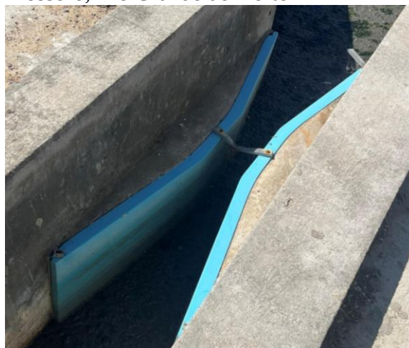
Figura 13 – Detalhe do medidor de vazão (calha Parshall) da Estação de Tratamento de Esgoto Vingt Rosado, no município de Mossoró, Rio Grande do Norte
