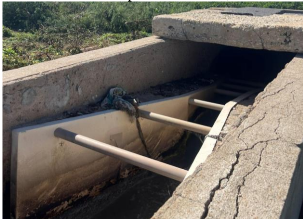
Figura 7 – Medidor de vazão (calha Parshall ) na Estação de Tratamento de Esgoto Cajazeiras, inseridas no município de Mossoró, Rio Grande do Norte
