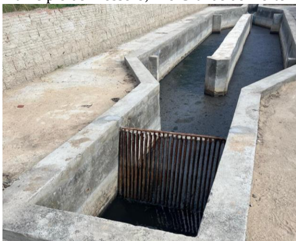
Figura 12 – Tratamento preliminar por gradeamento e caixa de areia na Estação de Tratamento de Esgoto Vingt Rosado, no município de Mossoró, Rio Grande do Norte
