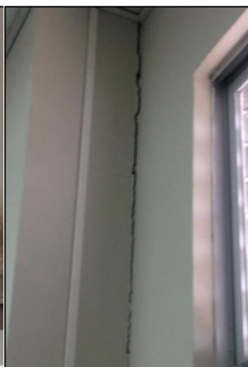
b. Fissura. Parte interna da sala de Cabine individuais da Biblioteca.
