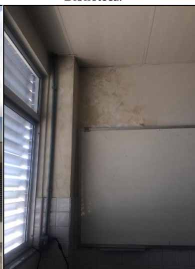
e. Manchas. Parte interna da sala de aula do Bloco Central I. Fonte: próprio Autor, 2018.
