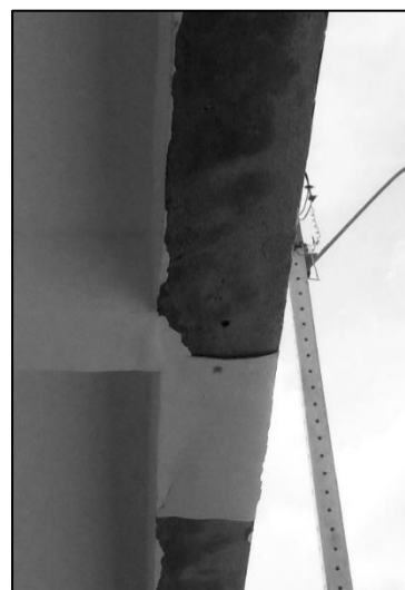
c. Desagregação de pintura. Parte externa do Bloco I de Sala de Aula.
