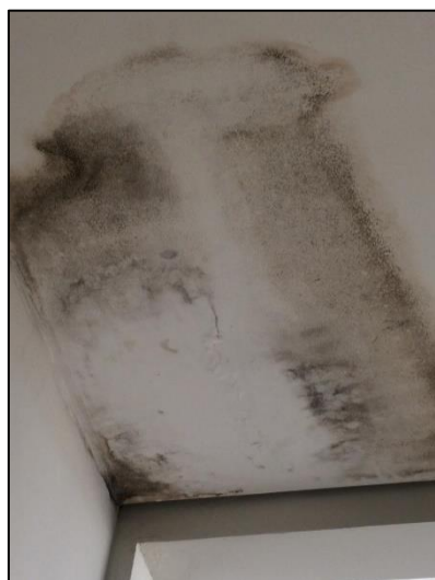
a. Bolor. Forro do corredor do Bloco Administrativo.
