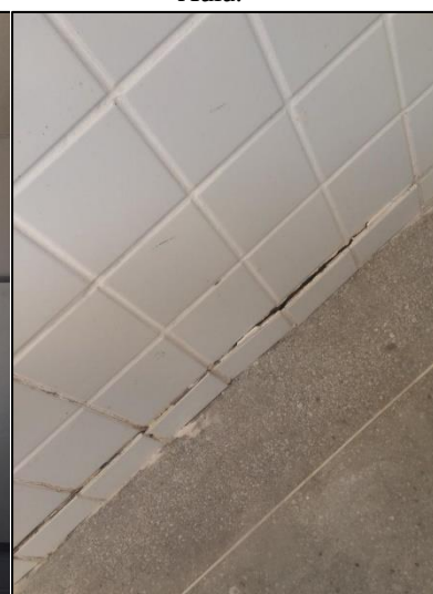
f. Eflorescência. Parte interna da sala de aula Bloco Central II.
