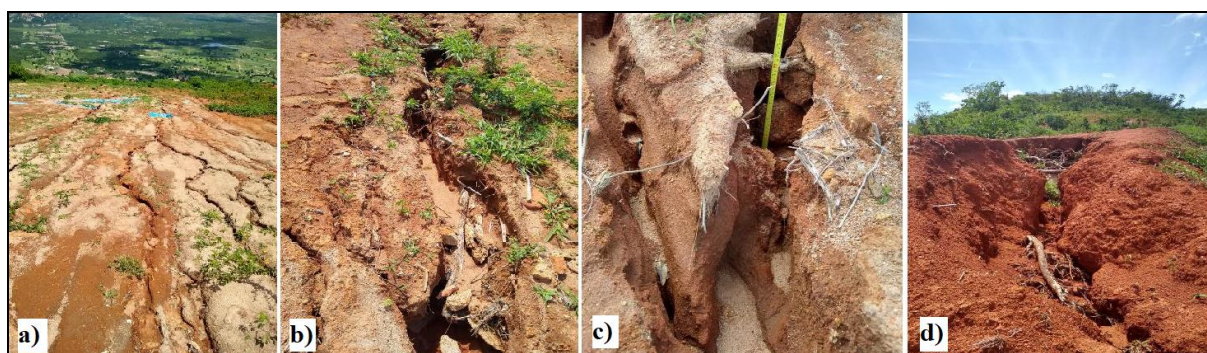
Figura 19 – Tipos de processos erosivos observados na rampa de voo livre de Patu/RN: laminar (a), em sulcos (b), em ravinas (c) e voçorocas (d)
