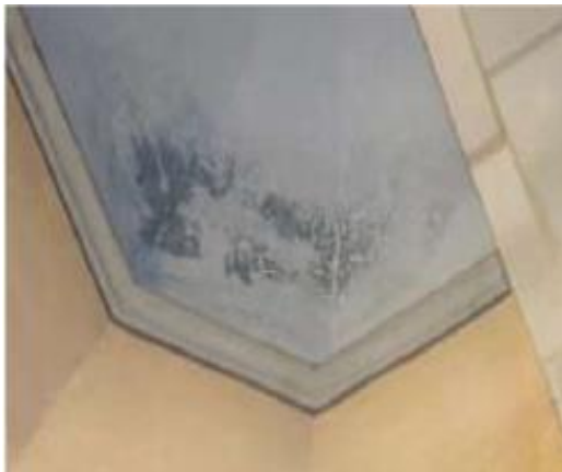
Figura 4: Manchas de umidade por infiltração em forro
