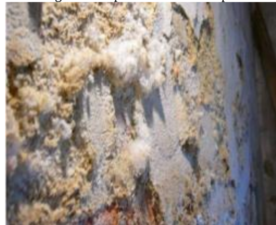
Figura 7: Criptoflorescência em parede
