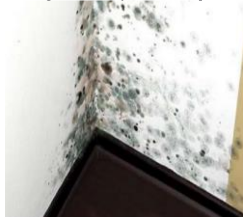
Figura 5: Presença de mofo em parede interna
