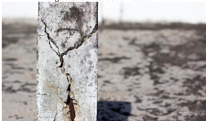
Figura 8: Corrosão da armadura
