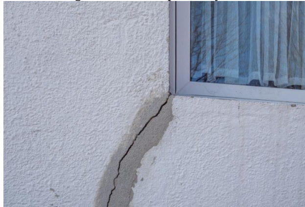
Figura 3: Trinca na ponta da janela.
