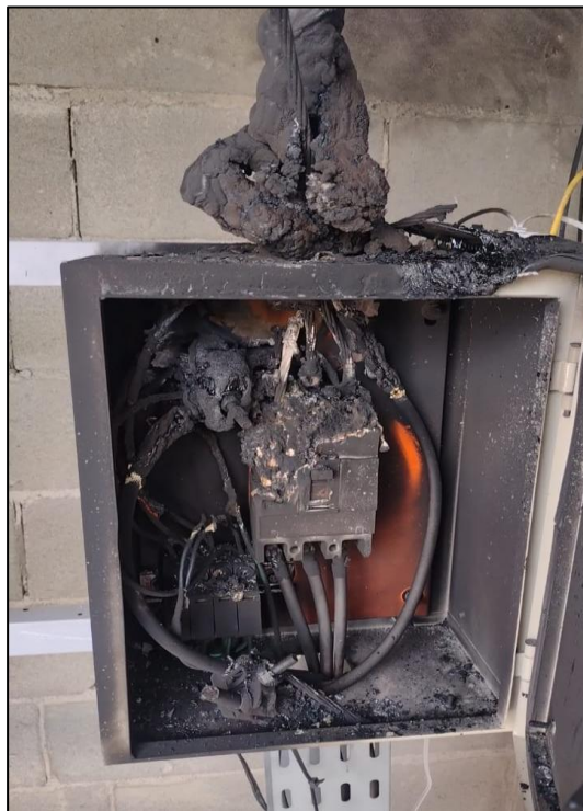
Figura 33 - Registro dos danos do incêndio na string box do inversor.
