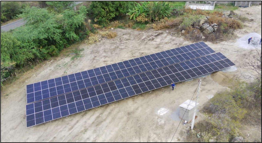
Figura 7 - Vista Superior da instalação de geração fotovoltaica.
