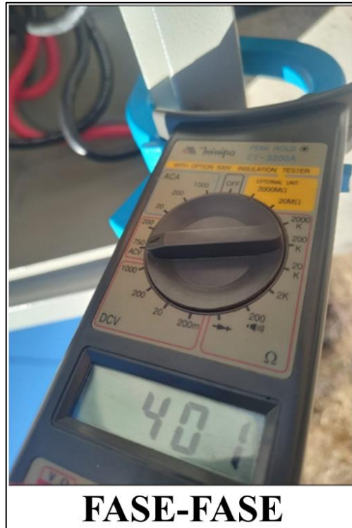
Figura 27 - Medição no padrão de entrada com multímetro no dia 25 de julho de 2025 (tensão de linha).
