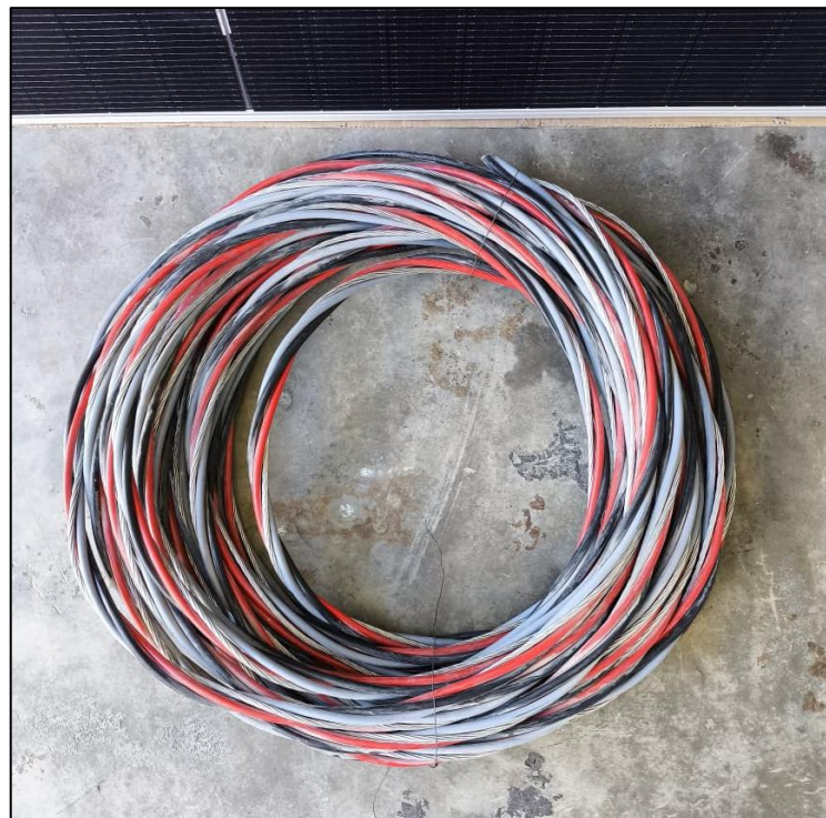
Figura 31 - Cabo de alumínio multiplexado com seção do condutor de 35mm 2 que conectava o inversor ao trecho existente da rede.
