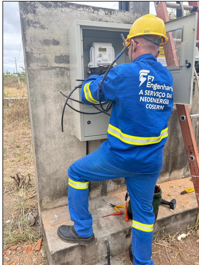
Figura 29 - Ordem de serviço realizada pela COSERN.
