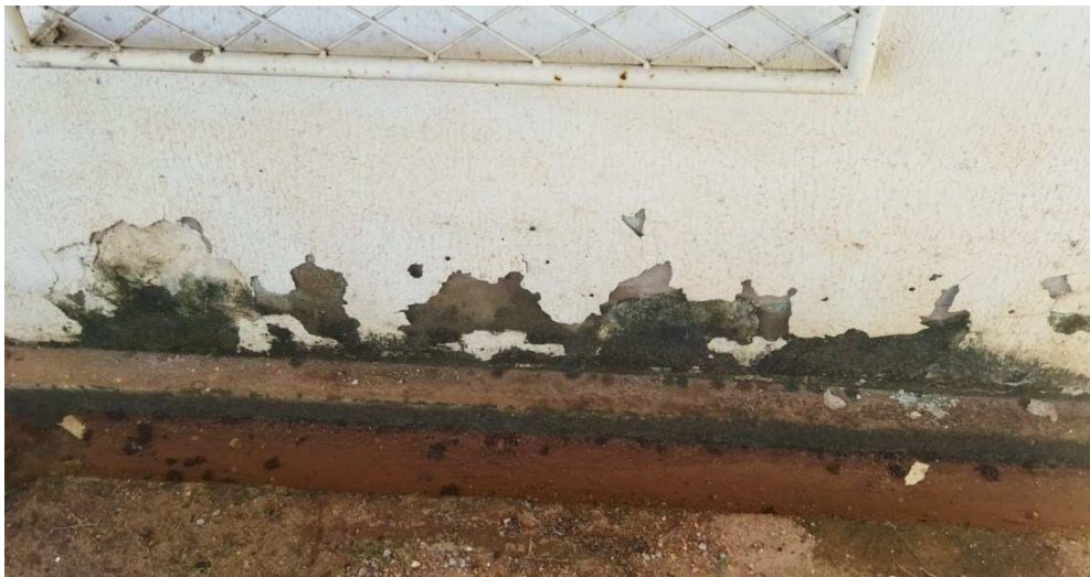
Figura 19: Umidade ascendente provocando deslocamento da argamassa e pintura.
