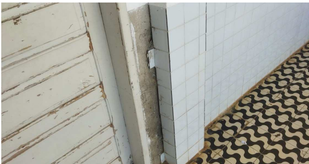
Figura 26: Revestimento destacando da parede.
