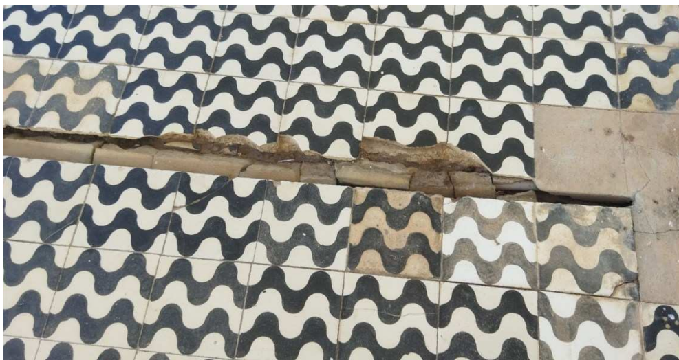
Figura 25: Revestimento quebrados e abertura de fenda.
