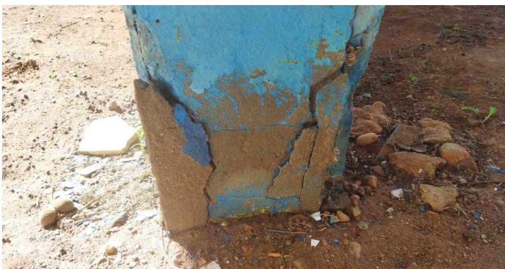
Figura 13: Pilar com fissuras, trincas e rachaduras.
