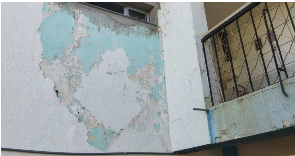
Figura 21: Pintura saindo da parede na área externa.
