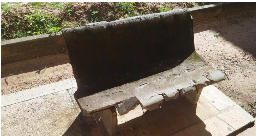
Figura 17: Banco com armaduras expostas.
