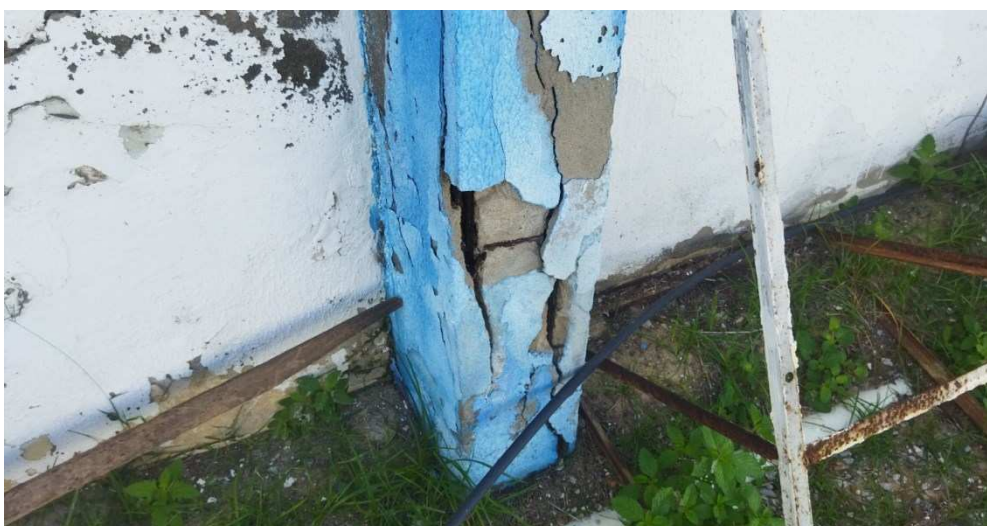
Figura 14: Pilar com rachaduras.
