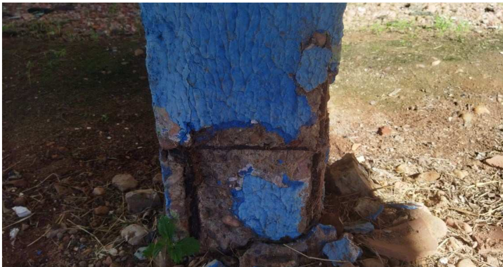
Figura 15: Pilar com armadura aparente e apresentando corrosão.
