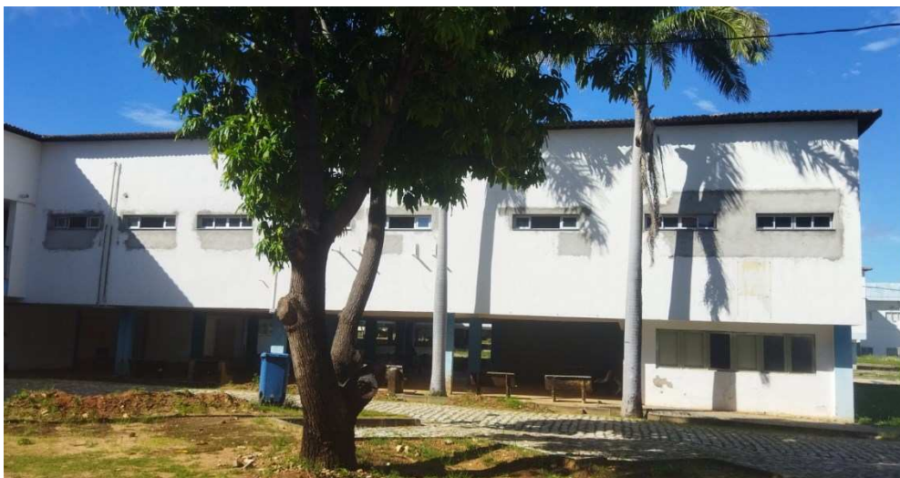
Figura 28: Área externa da edificação com a presença de argamassa exposta.
