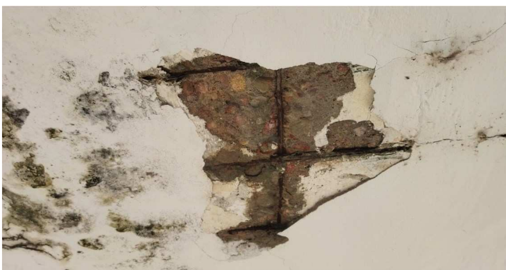
Figura 11: Deslocamento da argamassa e armadura exposta.
