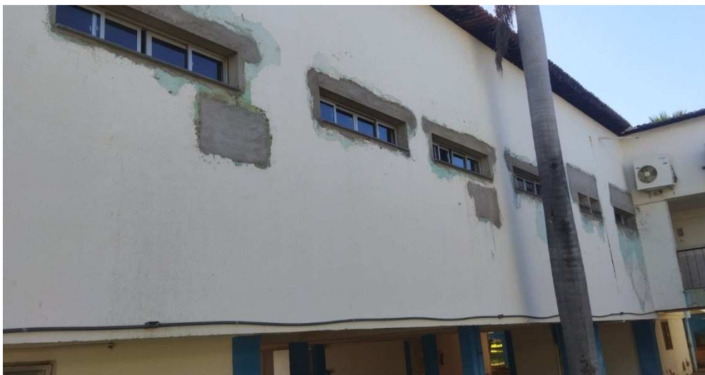
Figura 27: Área externa da edificação com sinais de manutenção.
