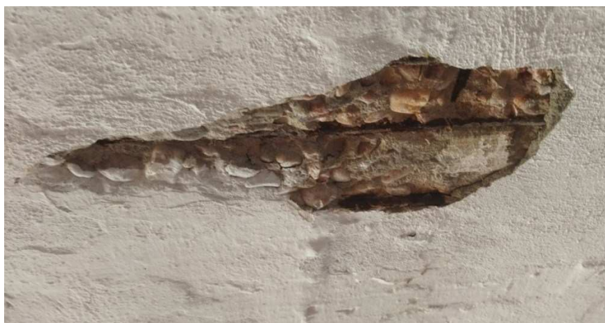
Figura 10: Desplacamento do concreto e exposição da armadura.
