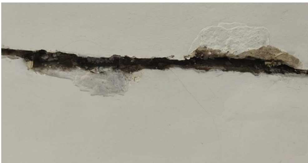
Figura 24: Rachadura no teto.
