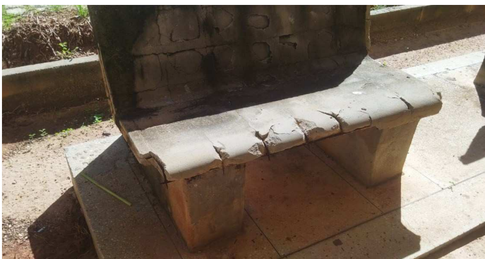
Figura 18: Deterioração de banco da edificação.
