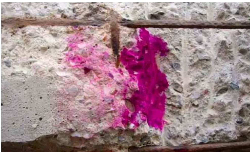
Figura 6: Ensaio para detecção de carbonatação com fenolftaleína.
