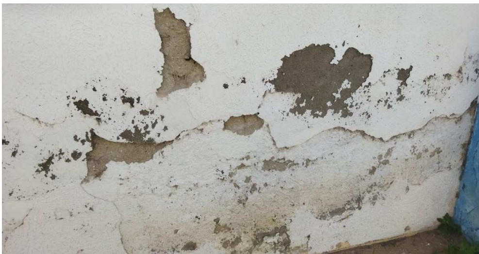
Figura 20: Pintura e reboco caindo.
