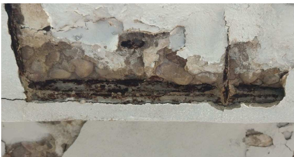
Figura 12: Corrosão na armadura.
