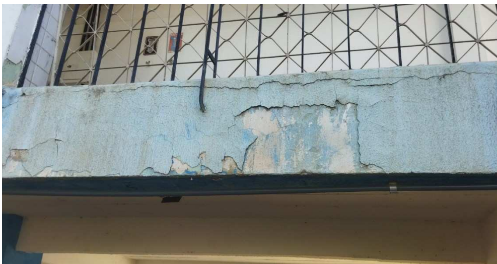
Figura 22: Pintura saindo da parede e presença de fissuras.
