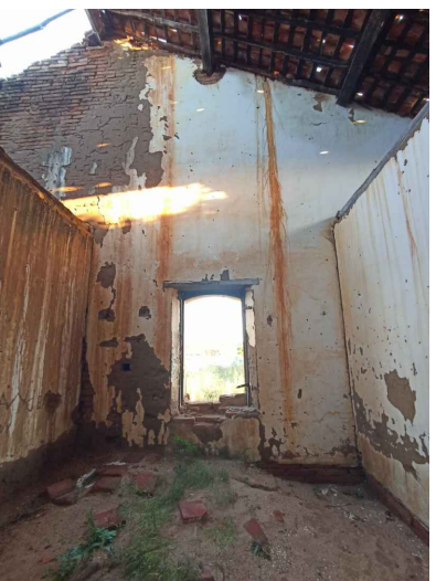
DEPLACAMENTO DE REBOCO: SALA
