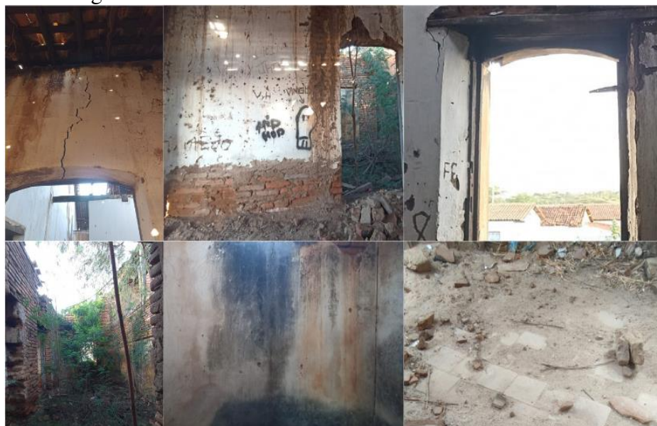
Figura 18 – Estado de revestimentos e alvenarias internas
