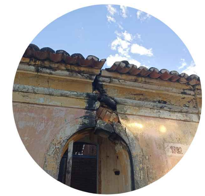
FOTO 01 - RACHADURA - FACHADA FRONTAL
