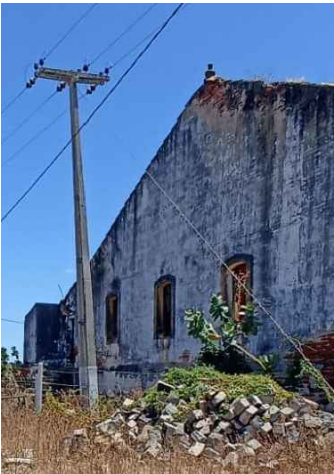
ALTERAÇÃO CROMÁTICA, DESCOLAMENTO DE REBOCO E ADOBE APARENTE - FACHADA NORTE
