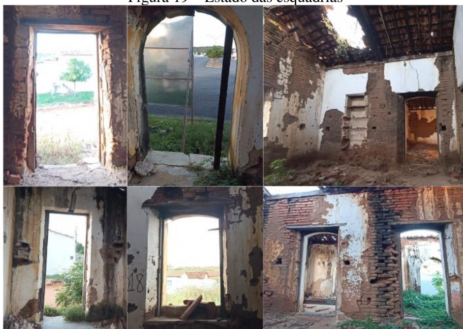
Figura 19 – Estado das esquadrias
