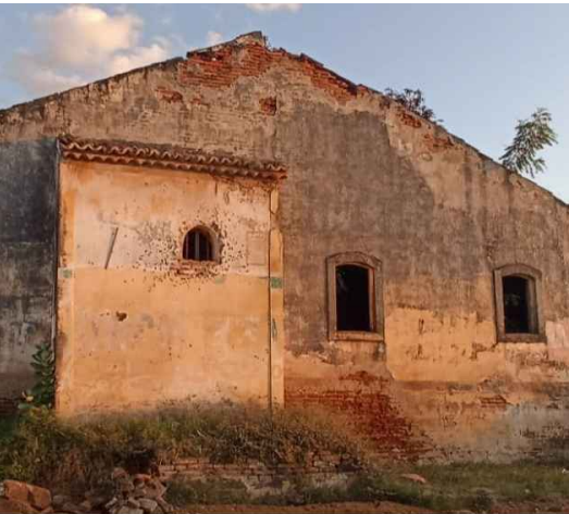
ALTERAÇÃO CROMÁTICA, DESPLACAMENTO DE REBOCO, VEGETAÇÃO E ADOBE APARENTE - FACHADA NORTE
