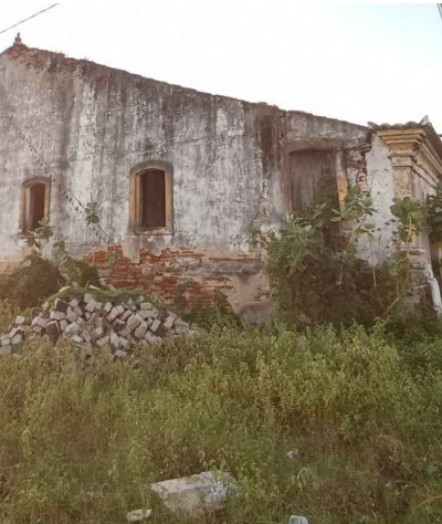
ALTERAÇÃO CROMÁTICA, VEGETAÇÃO, RACHADURA E ADOBE APARENTE - FACHADA NORTE
