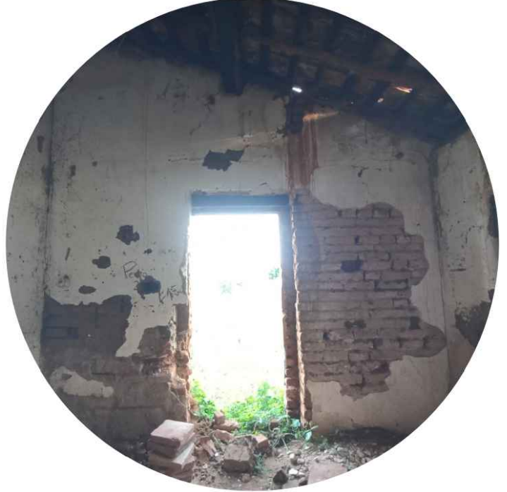
FOTO 08 - AUSÊNCIA DE ESQUADRIA - CIRCULAÇÃO COZINHA
