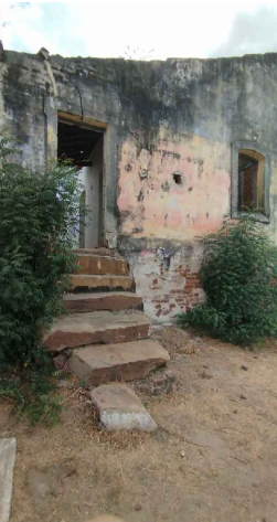
VANDALISMO, ALTERAÇÃO CROMÁTICA, DESPLACAMENTO DE REBOCO, VEGETAÇÃO E ADOBE APARENTE - FACHADA NORTE
