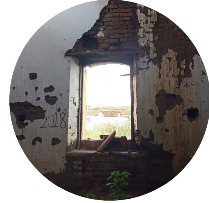
FOTO 07 - AUSÊNCIA DE ESQUADRIA - SALA DE JANTAR 02
