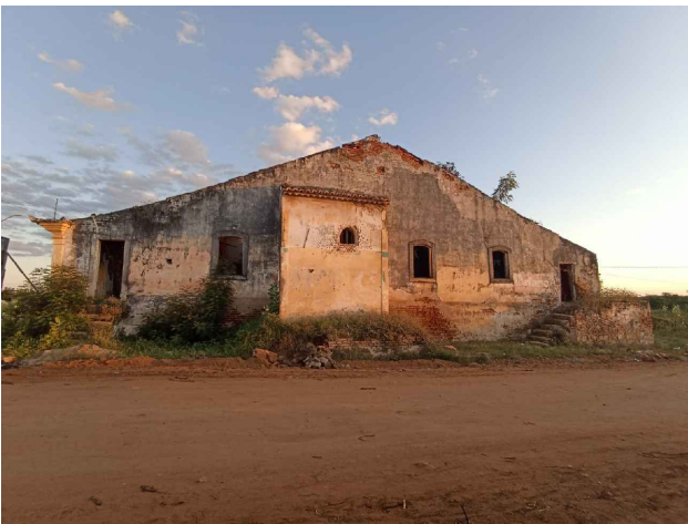
VANDALISMO, ALTERAÇÃO CROMÁTICA, DESPLACAMENTO DE REBOCO, VEGETAÇÃO E ADOBE APARENTE - FACHADA NORTE
