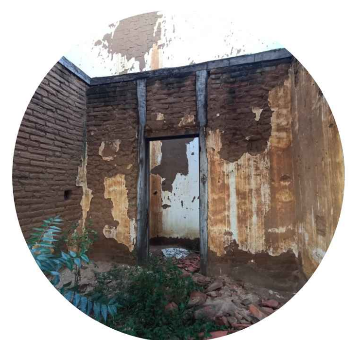
FOTO 05 - DESPLACAMENTO DE REBOCO - QUARTO 04
