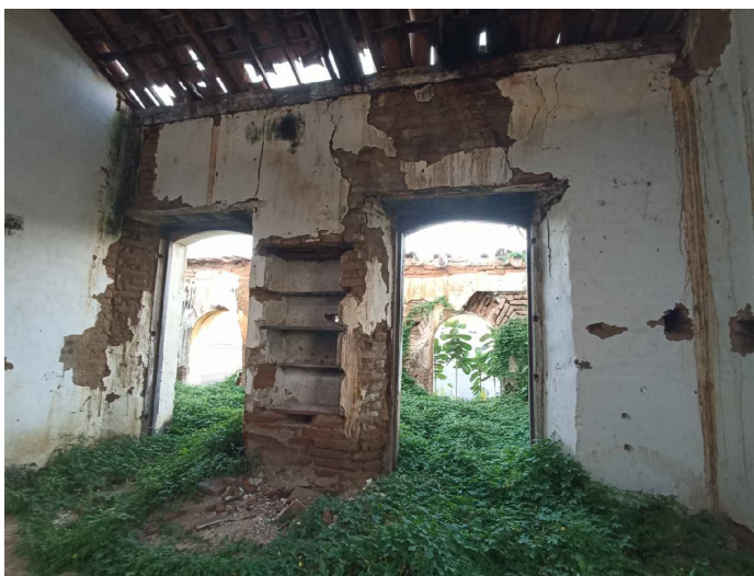
VEGETAÇÃO E TRINCAS: SALA E GUARITA
