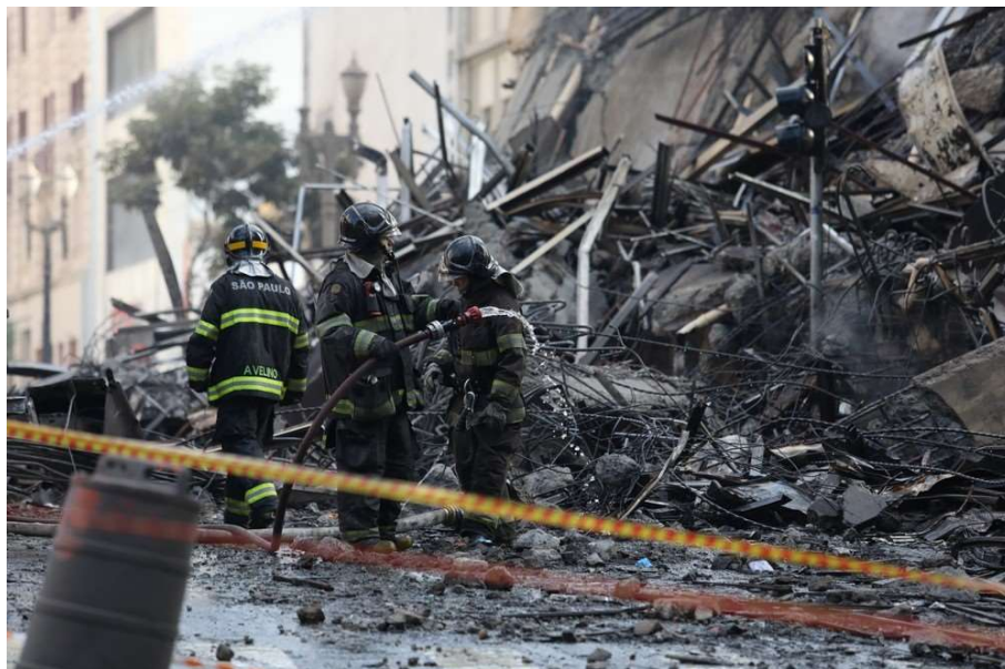
Figura 2. Escombros do edifício Wilton Paes de Almeida, que desabou após Incêndio em São Paulo Fonte: (Foto: Marcelo Brandt/G1).
