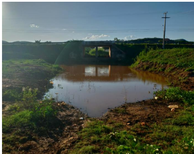
Figura 19: Acúmulo de água após a ponte
