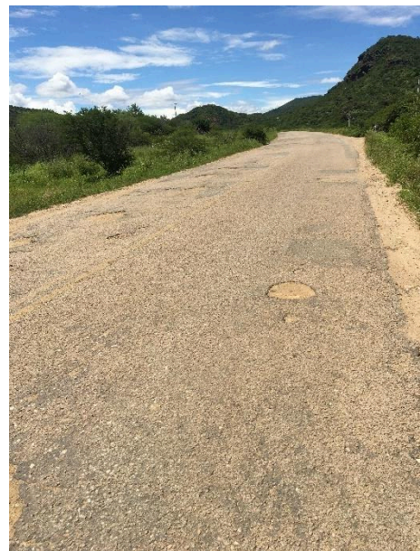
Figura 25: Remendos e panelas.
