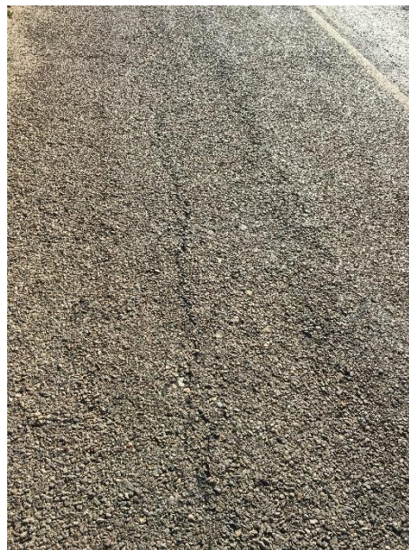
Figura 27: Trinca longitudinal e afundamento por trilha de roda.
