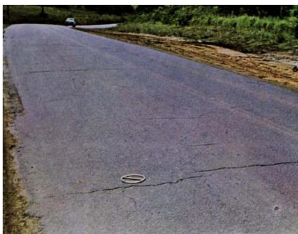
Figura 3: Trinca isolada transversal.
