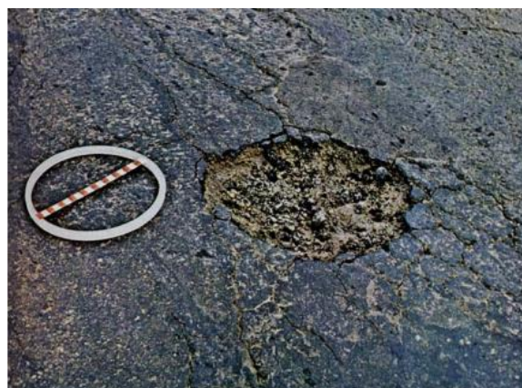
Figura 13: Panela ou buraco.
