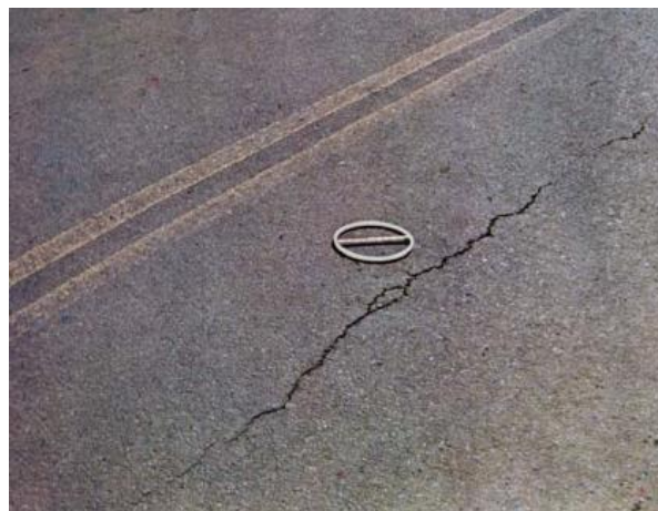
Figura 4: Trinca isolada longitudinal.
