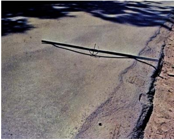
Figura 7: Afundamento de trilha de roda.
