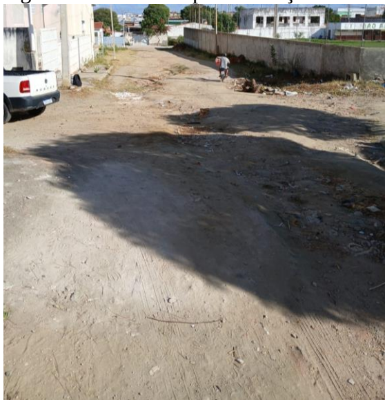
Figura 14 - Vias sem pavimentação.
