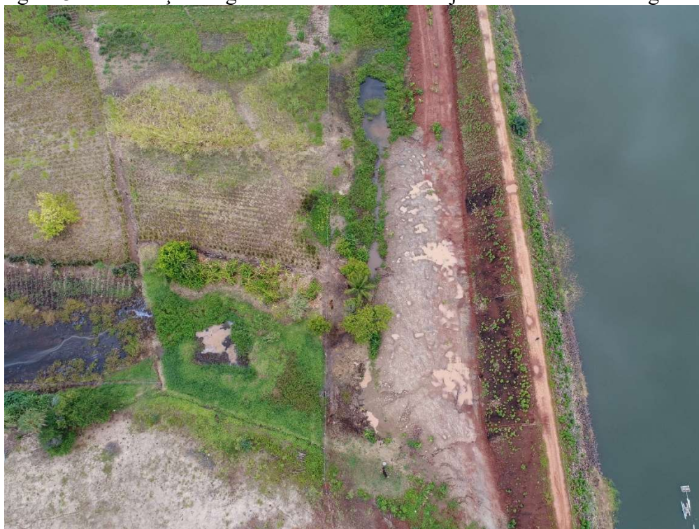
Figura 31 - Presença de água na base do talude de jusante barramento angicos
