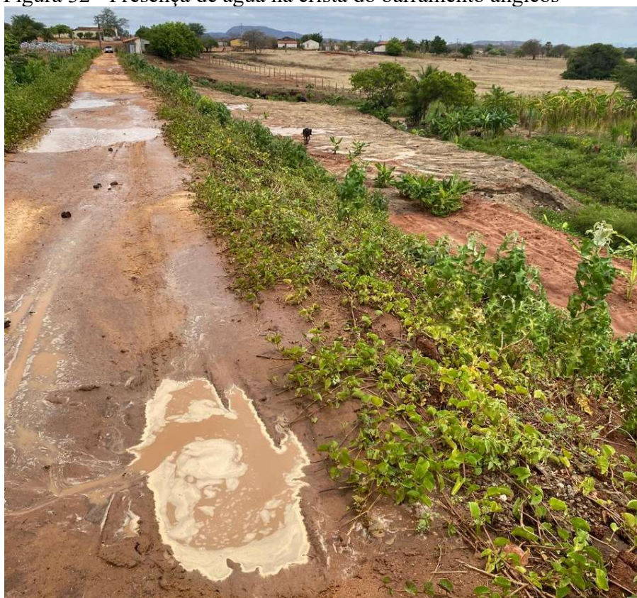
Figura 32 - Presença de água na crista do barramento angicos
