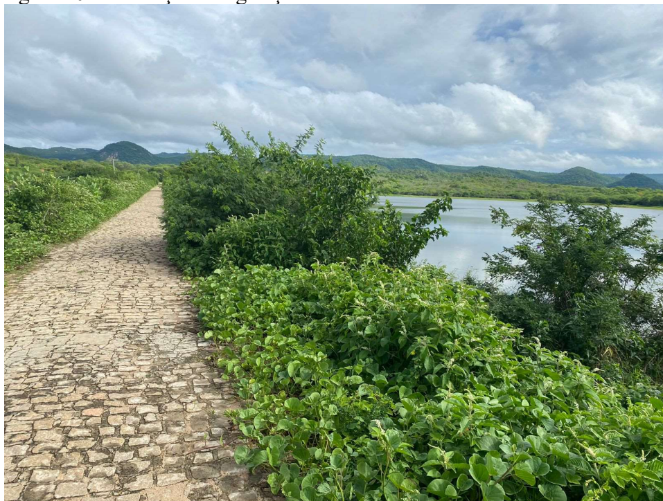
Figura 40 - Presença de vegetação no barramento do corredor
