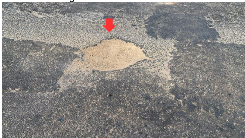
Figura 28 - Panela ou buraco
