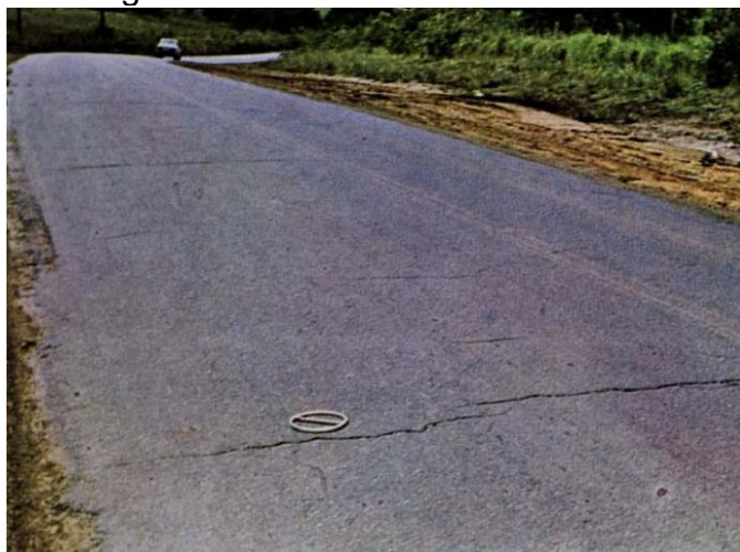
Figura 3 - Trinca isolada: transversal
