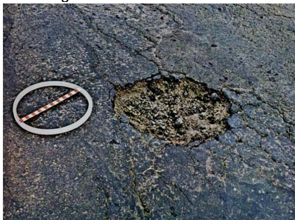
Figura 14 - Panela ou buraco
