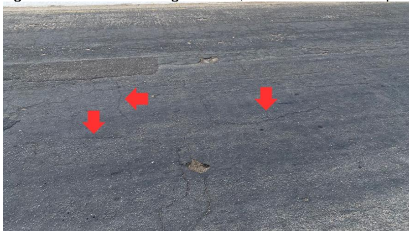
Figura 21 - Fissuras longitudinais, transversais e oblíquas
