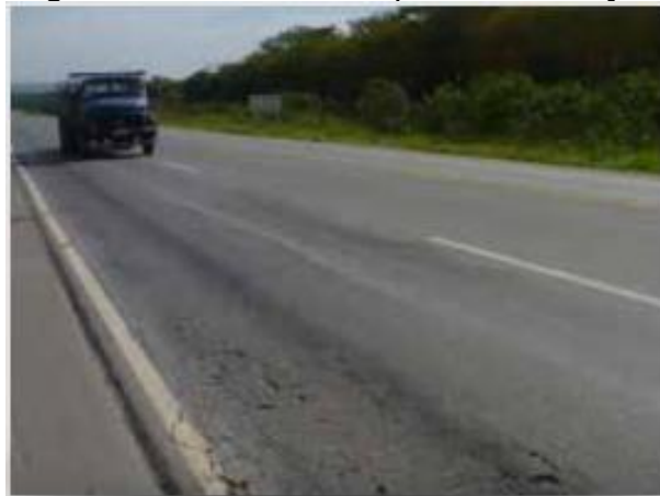
Figura 9 - Afundamento por consolidação
