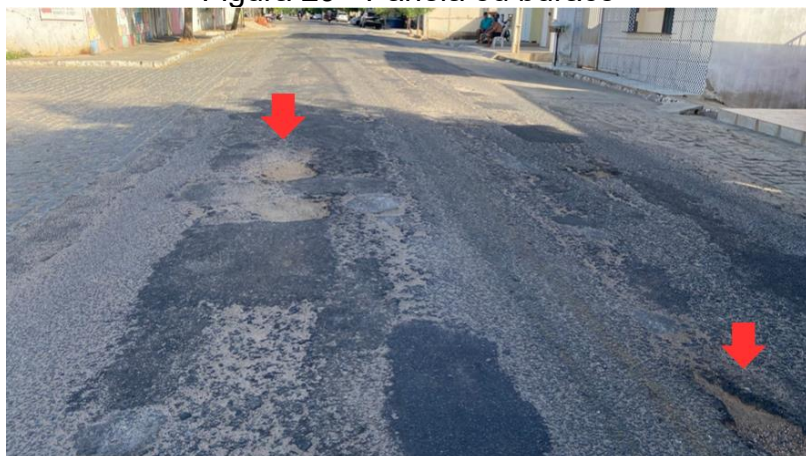
Figura 29 - Panela ou buraco
