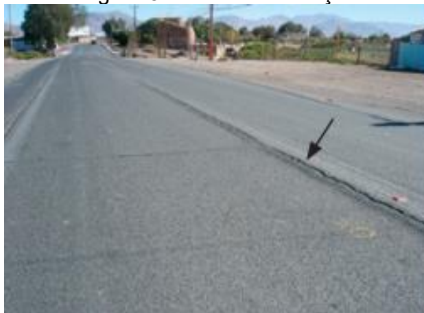
Figura 5 - Trinca de retração
