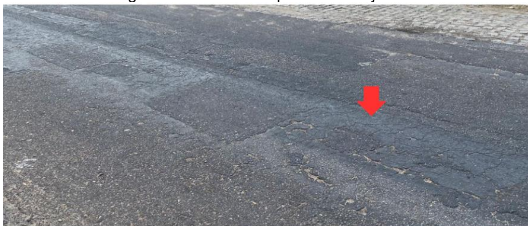
Figura 23 - Trinca do tipo “couro de jacaré”
