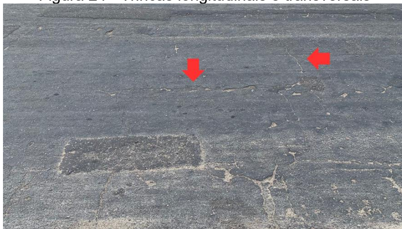
Figura 24 - Trincas longitudinais e transversais
