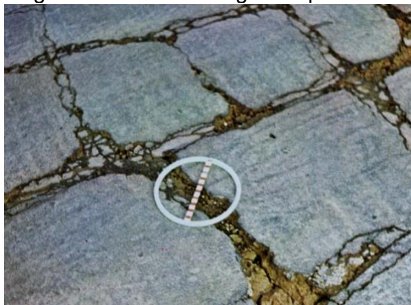
Figura 7 - Trinca interligada: tipo “bloco”
