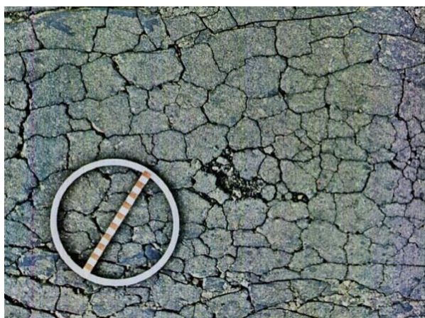
Figura 6 - Trinca interligada: tipo "couro de jacaré"
