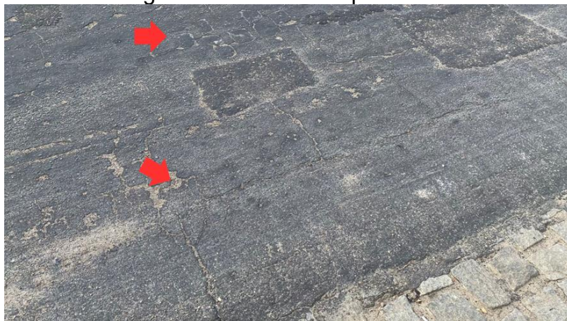
Figura 22 - Trinca do tipo “bloco”
