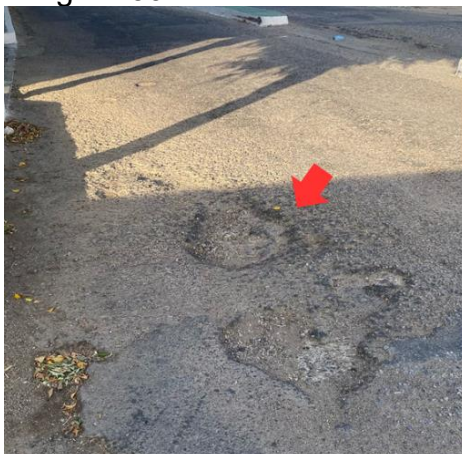
Figura 30 - Panela ou buraco
