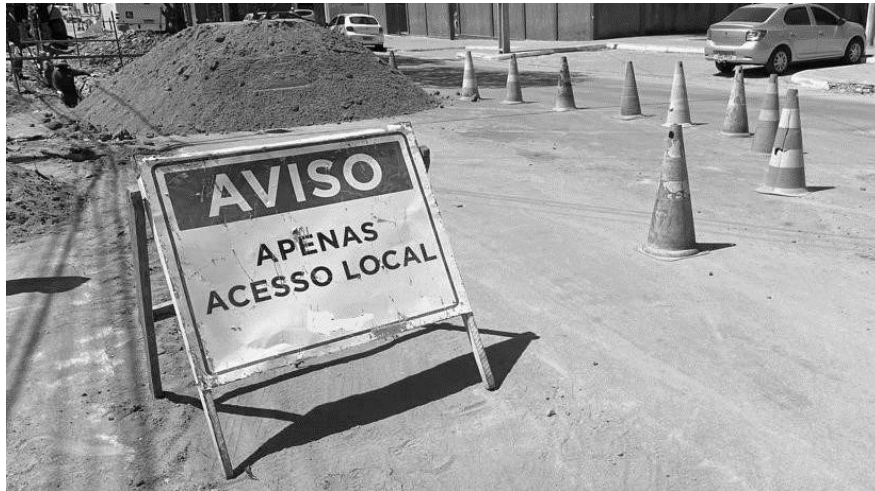
Figura 14: Sinalização de segurança Fonte: Autoria própria (2024).
