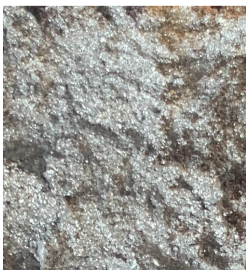
Figura 22- Superfície da fratura (Fonte: Autoria própria)
