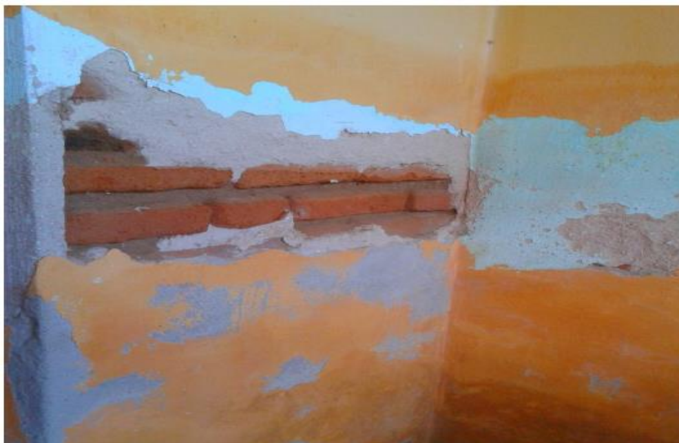
Figura 7 - Eflorescência acentuada na alvenaria
