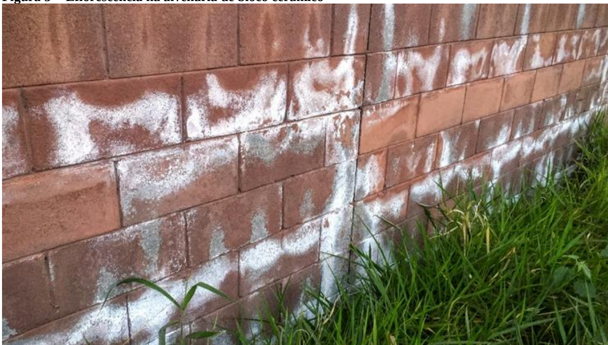
Figura 5 - Eflorescência na alvenaria de bloco cerâmico
