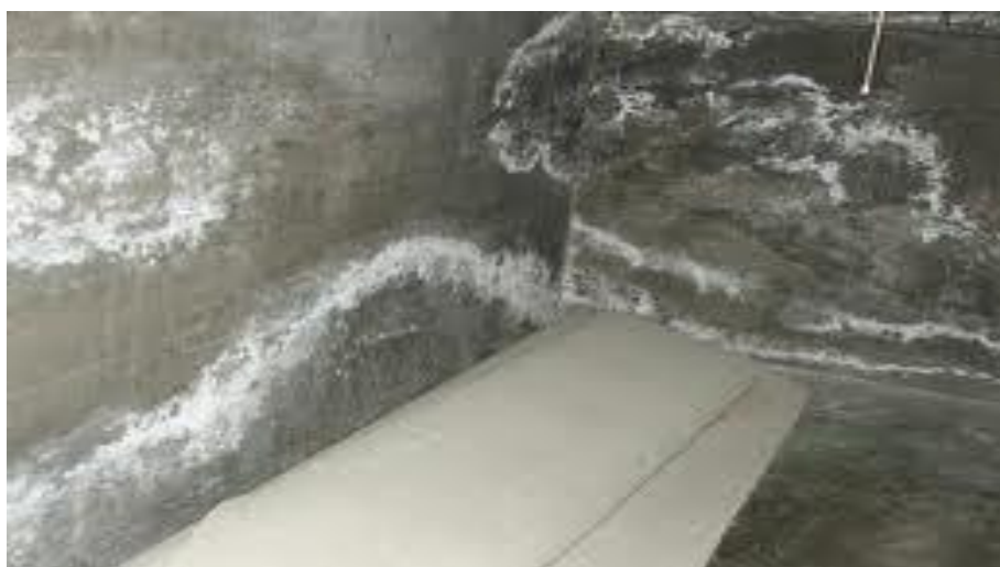
Figura 2 - Eflorescência em alvenaria
