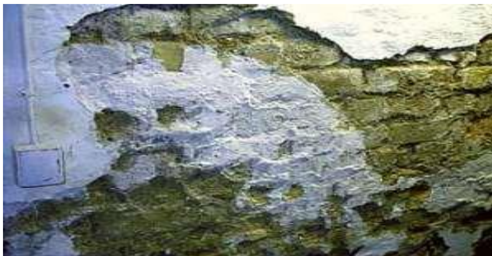
Figura 1 - Subflorescência em alvenaria
