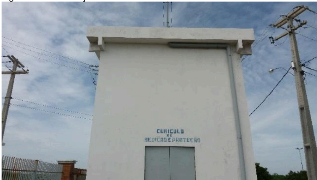
Figura 24 - Subestação da UFERSA – Caraúbas.
