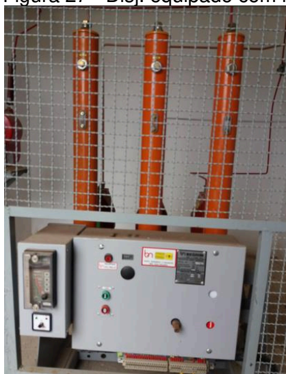
Figura 27 - Disj. equipado com relé - UFERSA – Caraúbas.
