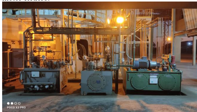
Fig. 6 – Unidades Hidráulicas [Autoria própria].
