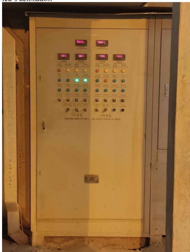
Fig. 7 – Painel de unidade hidráulica [Autoria própria].
