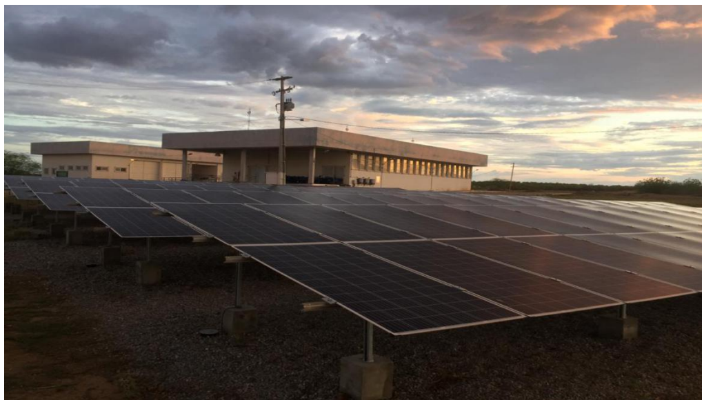
Figura 3 - Usina Solar Fotovoltaica da UFERSA – Angicos
