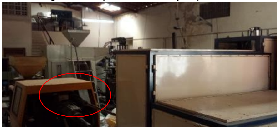
Figura 16 - Maquinas elétricas sem proteção isolante
