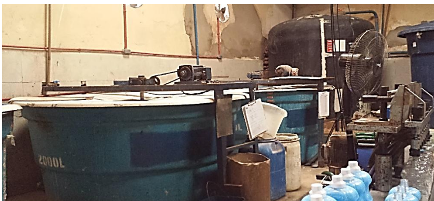
Figura 21 - Bombas, maquinas e fios expostos
