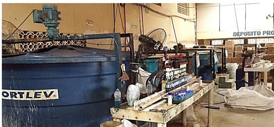
Figura 22 - Equipamentos elétricos sem proteção
