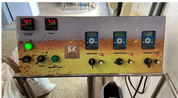
Figura 4 – Painel de controle da cozinha
