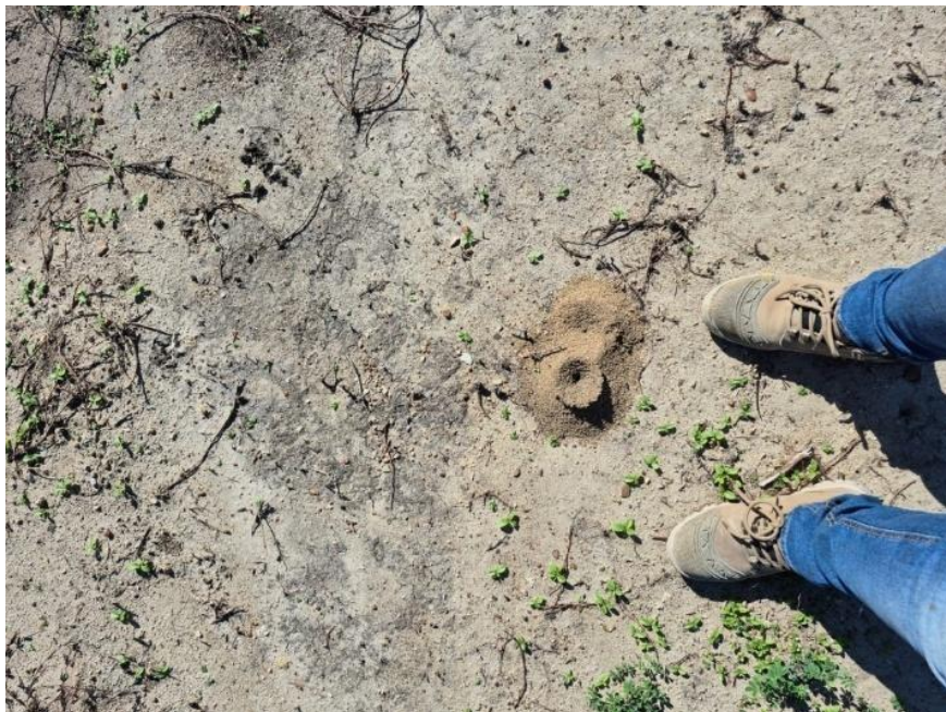
Figura 14 – Presença de formigueiros na ombreira direita do reservatório
