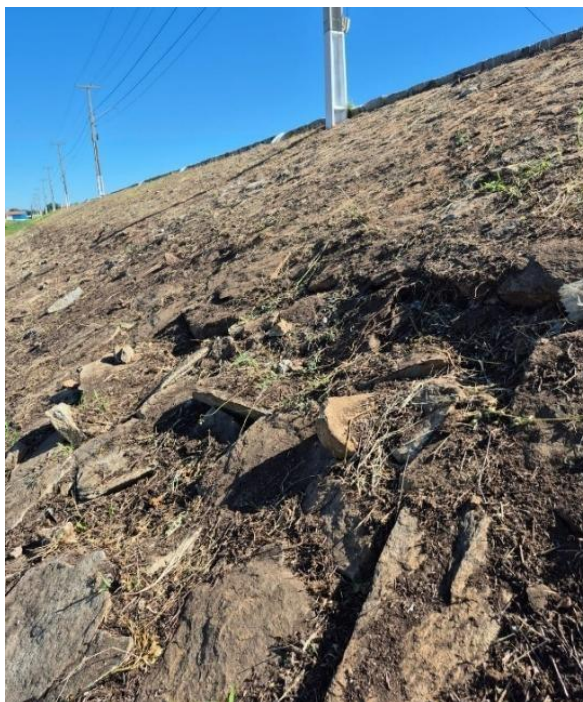
Figura 11 – Descolamento do maciço que compõem o “ Rip rap ” do talude de montante da barragem da vinte e cinco de Março
