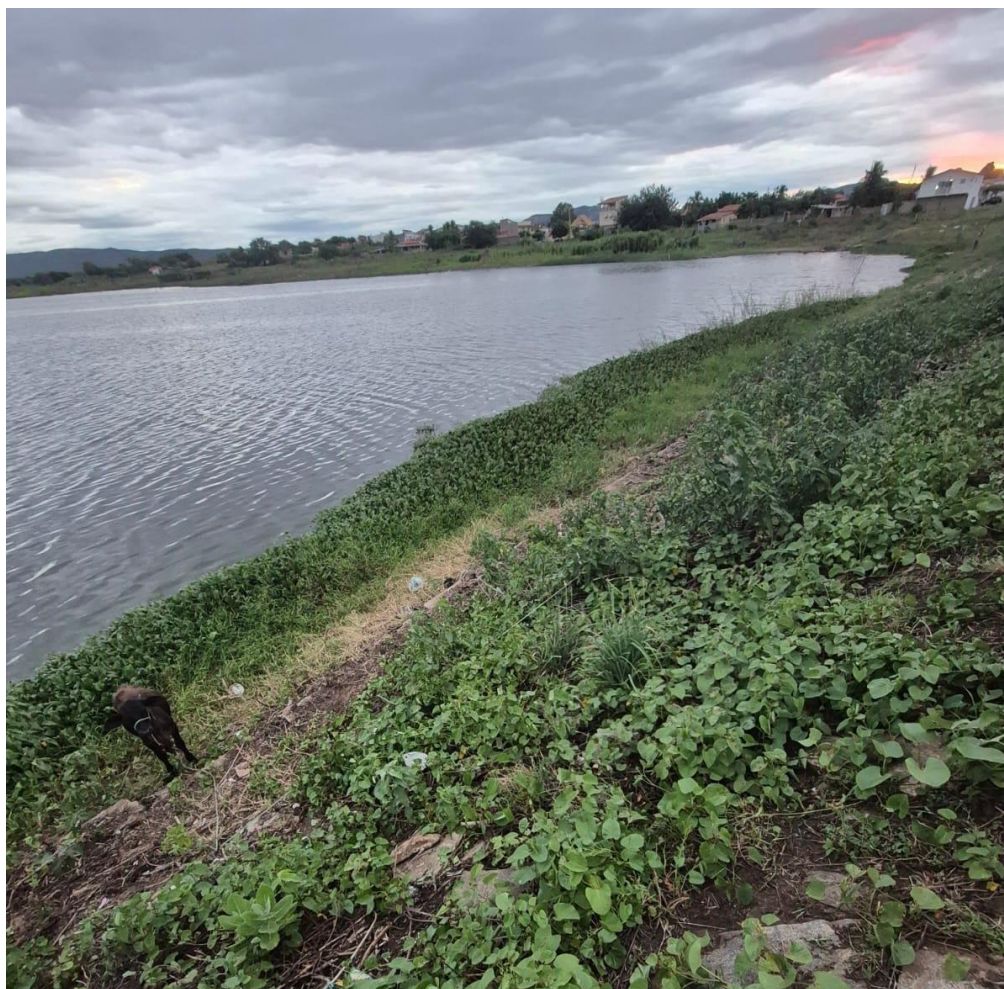
Figura 12 – presença de vegetação e animais no talude de montante
