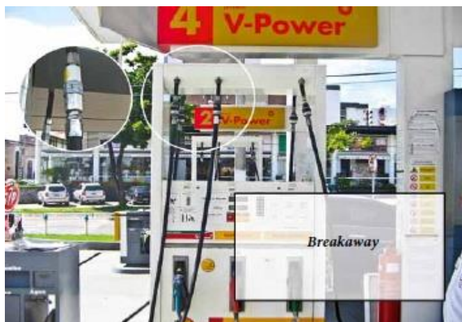
Figura 10 - Válvulas Breakaways instaladas nas mangueiras das bombas de combustível.
