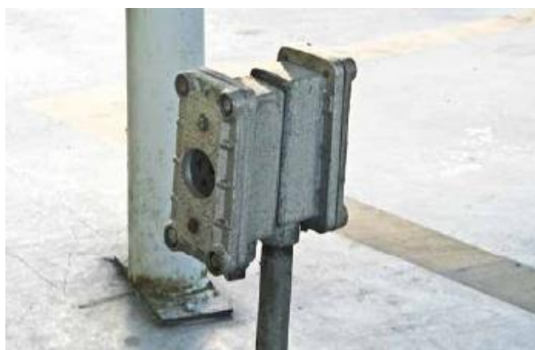
Figura 11 - Tomada elétrica instalada a uma altura superior a 0,5 m.
