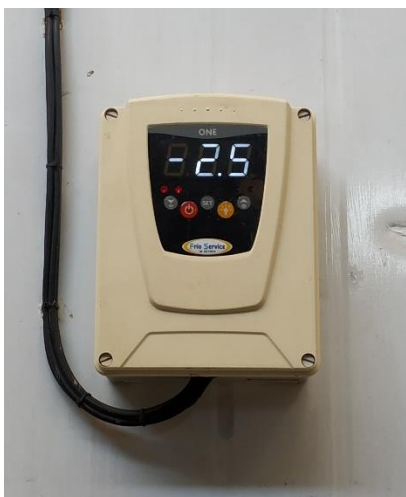
Figura 12 – Temperatura indicada pelo termômetro da câmara fria
