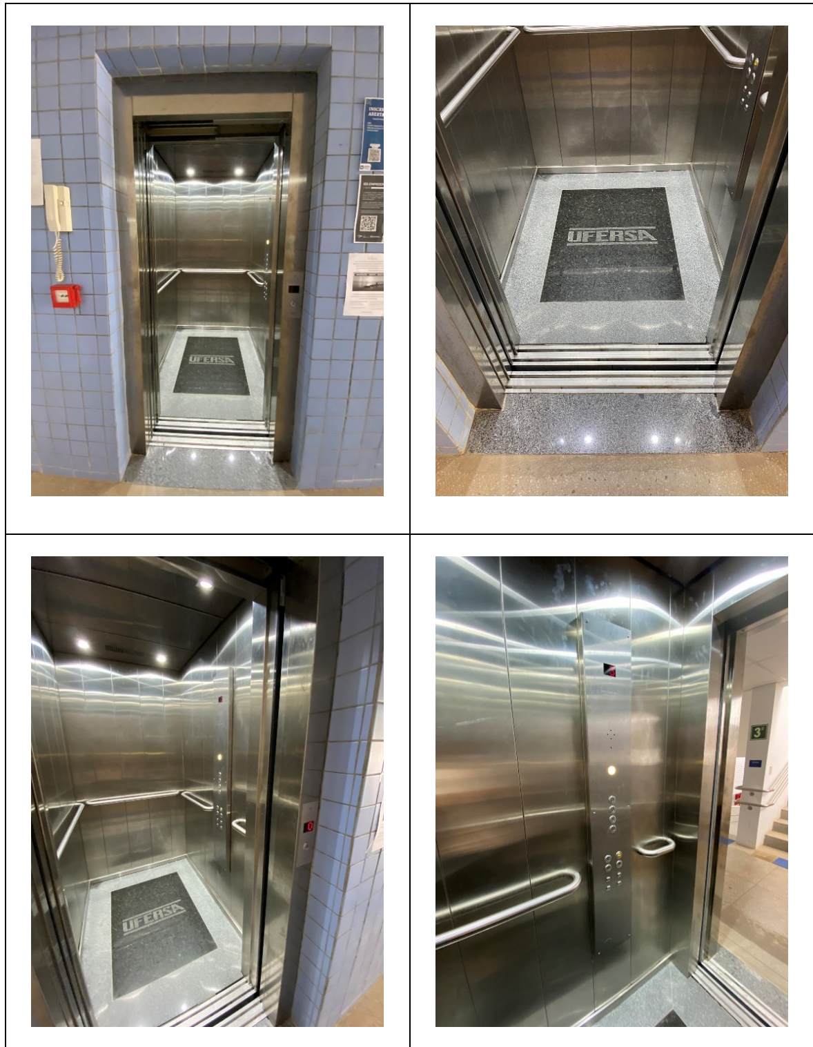
Figura 26 – Elevador esquerdo da edificação estudada
