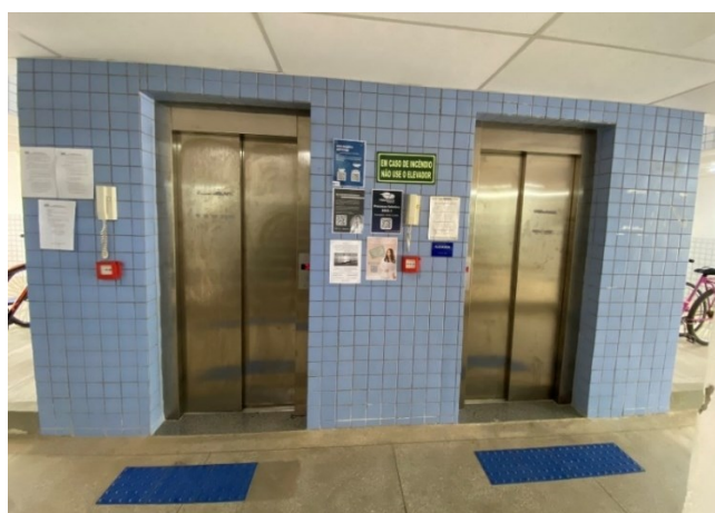
Figura 25 – Elevadores da edificação estudada
