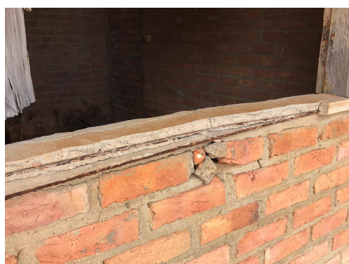
Figura 4A. Exposição da armadura corroída. (Autoria Própria).
