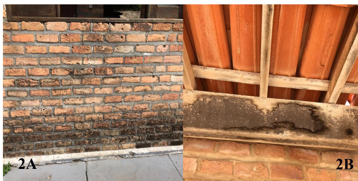
Figura 2. Manchas na parede e degradação do material. (Autoria Própria)
