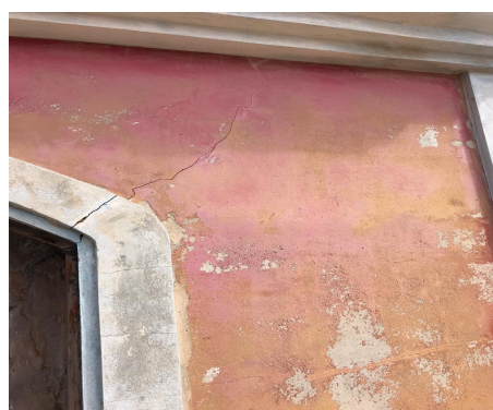
Figura 4B. Fissura presente na parede da edificação. (Autoria Própria)
