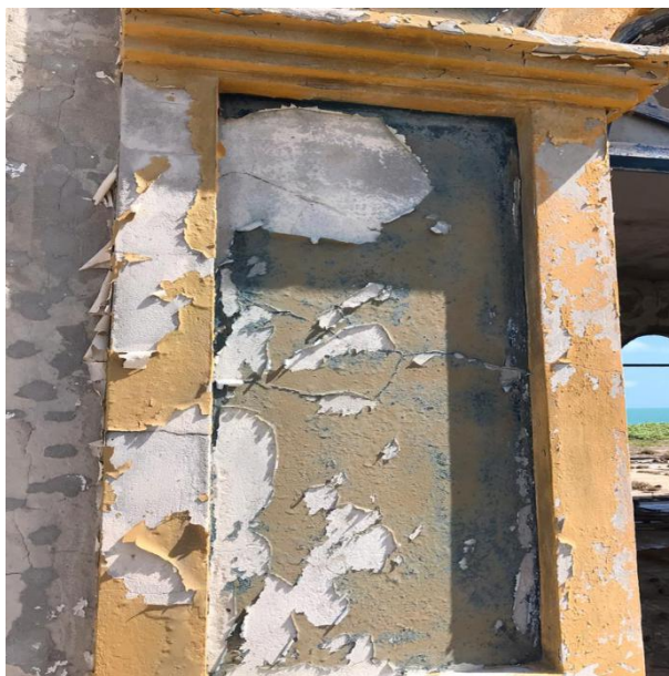
Figura 5. Destacamento do revestimento. (Autoria Própria)
