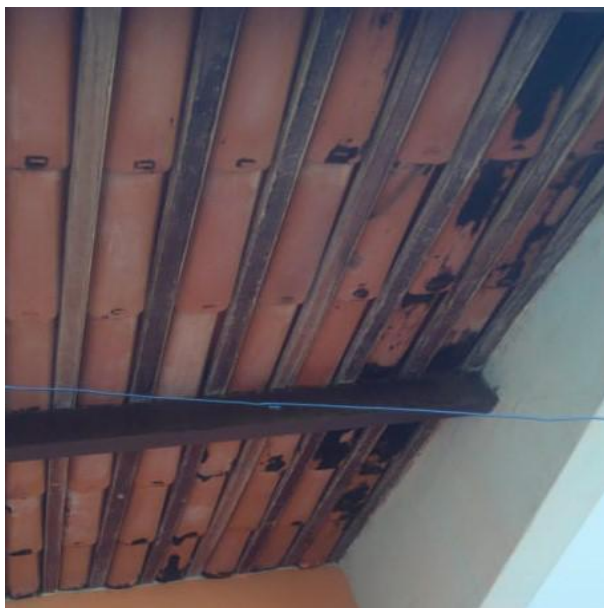
Figura 6. Presença de manchas e bolor nas telhas cerâmicas. Fonte: Autoria Própria.
