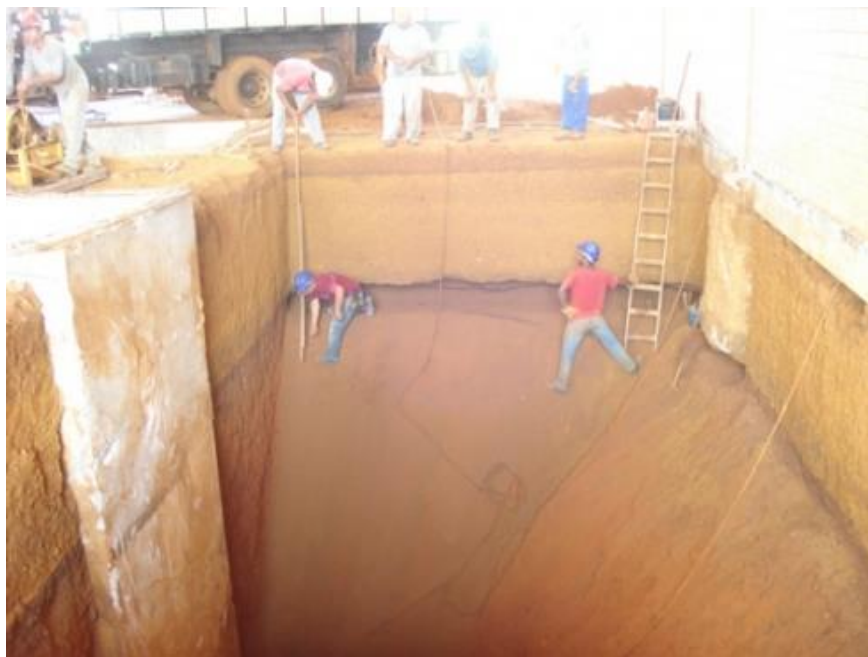
Figura 2 - Condições inseguras expõem os trabalhadores a riscos de acidentes com a escada
