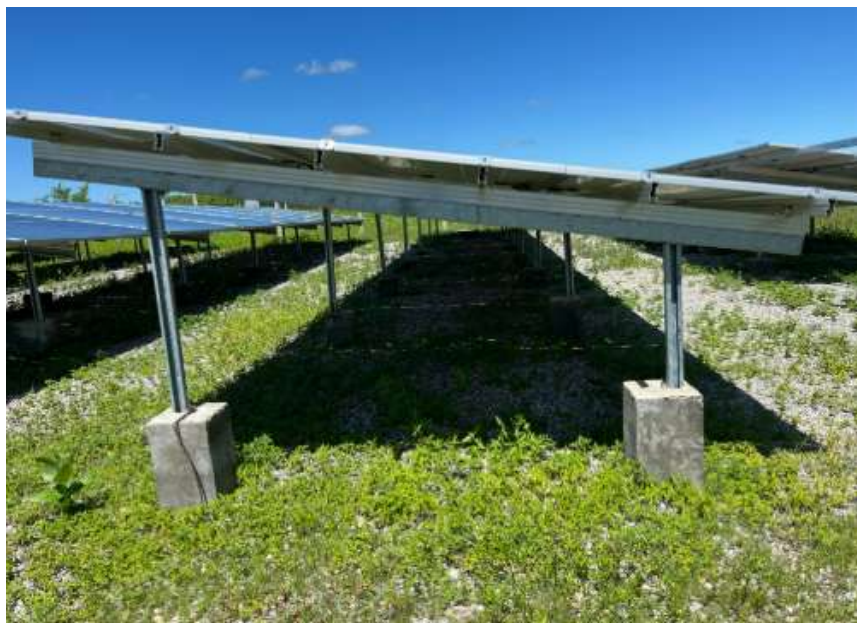
Figura 5 – Estruturas de suporte para painéis solares
