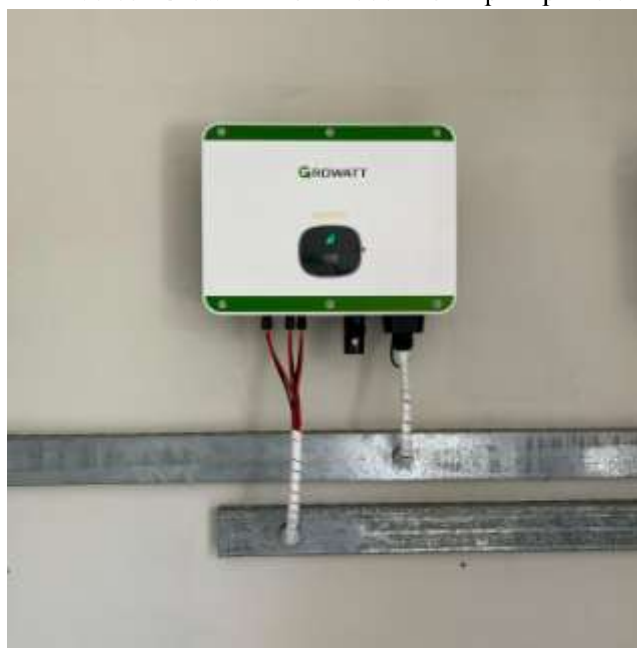
Figura 4 - Inversor Growatt MOD 4000TL3-X para painéis solares.
