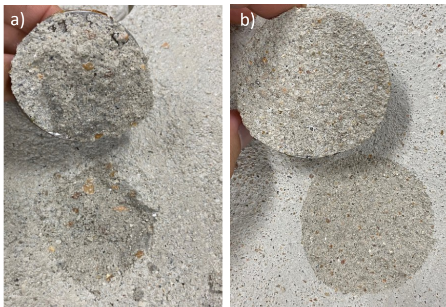
Figura 25 – Rupturas ocorridas no ensaio de resistência de aderência à tração superficial: ruptura no interior do revestimento (a) e ruptura da superfície do revestimento (b)
