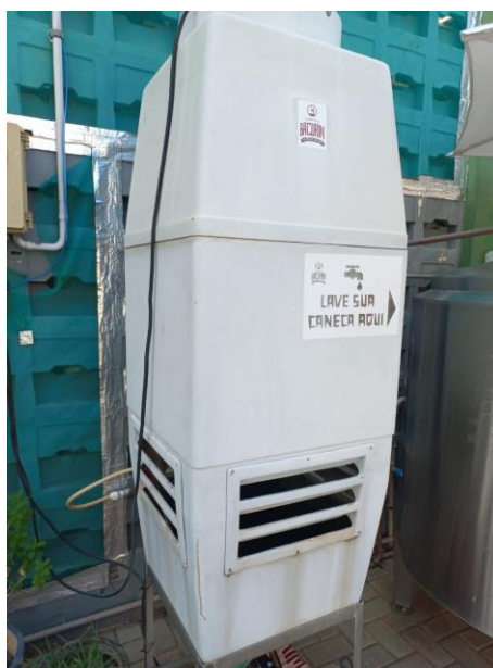
Figura 4 - Torre de resfriamento. Fonte: Autoria Própria (2022).
