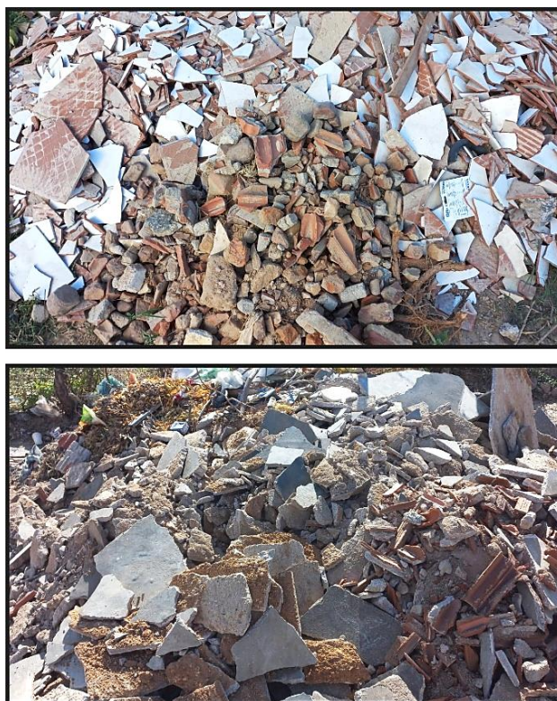
Figura 13 - Resíduos condicionados nas imediações dos canteiros de obras.
