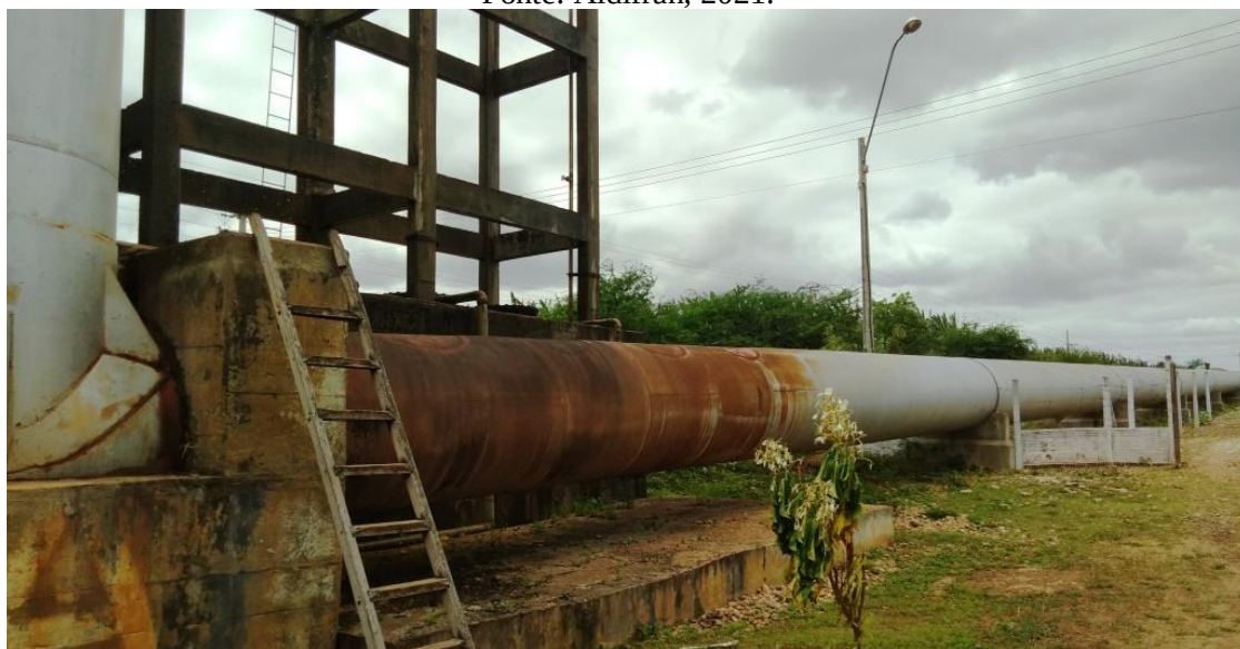
Figura 8: Duto principal que liga a estação de bombeamento principal a entrada no canal (Alto do Rodrigues/ /RN). Fonte: Aldifran, 2021.
