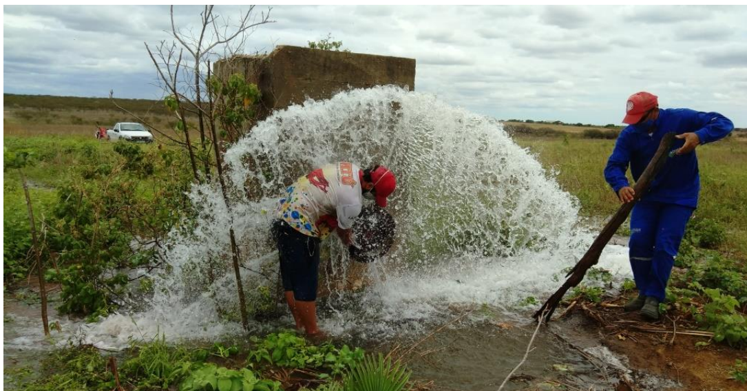
Figura 14: Válvula de descarga (Afonso Bezerra/ /RN). Fonte: Aldifran, 2021.
