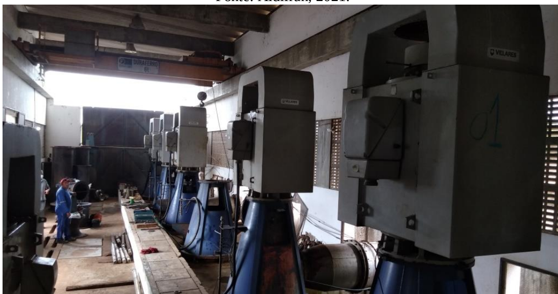
Figura 6: Conjunto Motobombas da Estação principal (Alto do Rodrigues/RN). Fonte: Aldifran, 2021.
