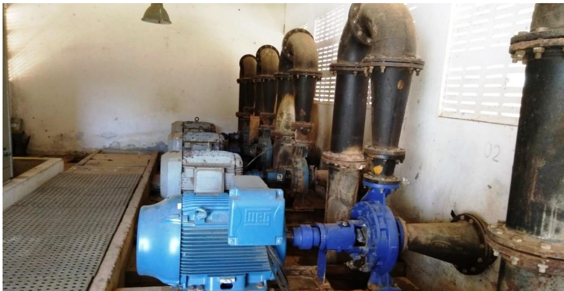
Figura 12: EB II Conjunto de motobombas do Setor 02 (Alto do Rodrigues/ /RN). Fonte: Aldifran, 2021.
