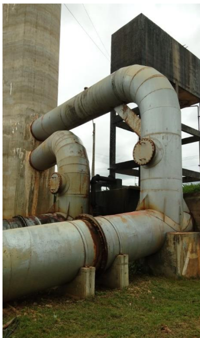
Figura 7: Estação principal dispositivo para controle do golpe de Aríete (Alto do Rodrigues/ /RN). Fonte: Aldifran, 2021.
