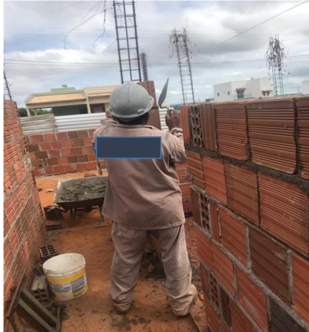
Figura 5: Trabalhador em não conformidade com a NR 6.
