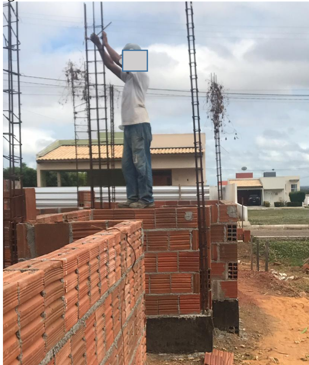
Figura 6: Trabalhador sem o uso de EPI's na obra 1.
