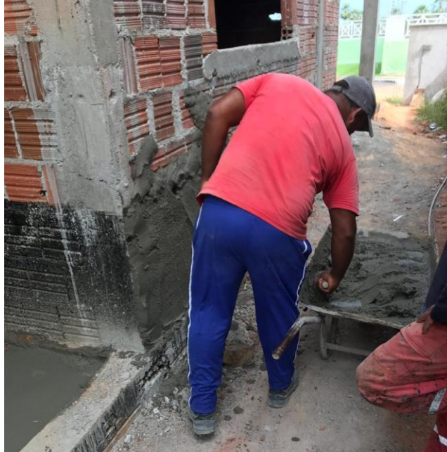
Figura 12: Operário na obra 2 sem o uso de EPI's.
