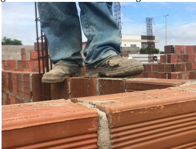
Figura 7: Trabalhador com bota desgastada na obra 1.
