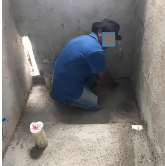
Figura 34: Trabalhador sem luvas, sem capacete e proteção dos braços.
