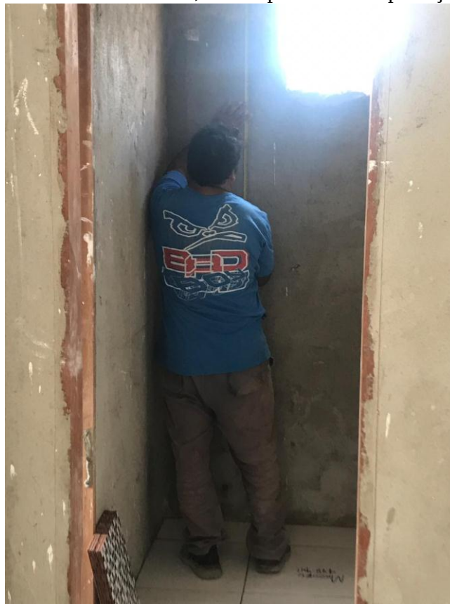
Figura 33: Trabalhador sem luvas, sem capacete e sem proteção dos braços.
