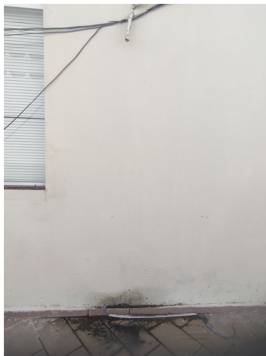
Figura 4.15 – Ponto de Infiltração acima da Galeria de Fotos.
