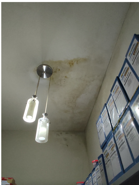
Figura 4.10 – Manchas e mofo na sala de arquivos.
