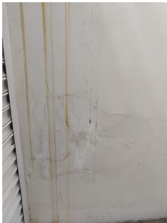
Figura 4.5 – Efflorescência, mofo e bolor da garagem da Câmara Municipal.
