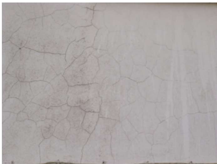
Figura 2.5 – Fissuras em revestimento argamassado.
