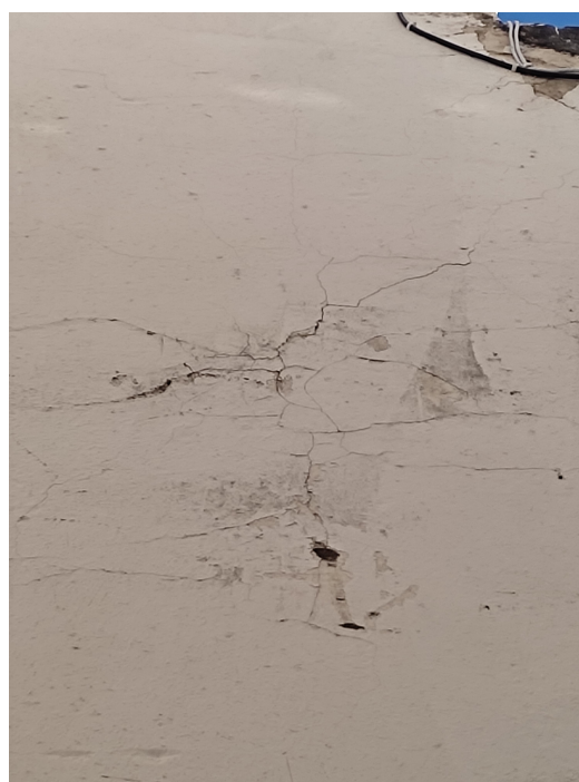
Figura 4.17 – Fissuras Mapeadas na Fachada lateral esquerda.
