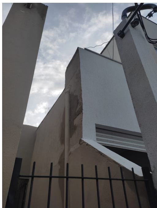
Figura 4.6 – Mancha de umidade na parte externa da garagem
