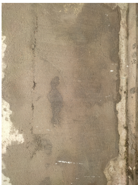
Figura 4.16 – Reboco Pulverulento na fachada lateral direita.
