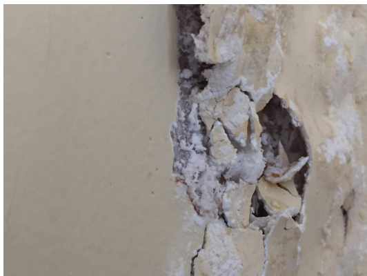
Figura 2.1 – Eflorescência em argamassa.
