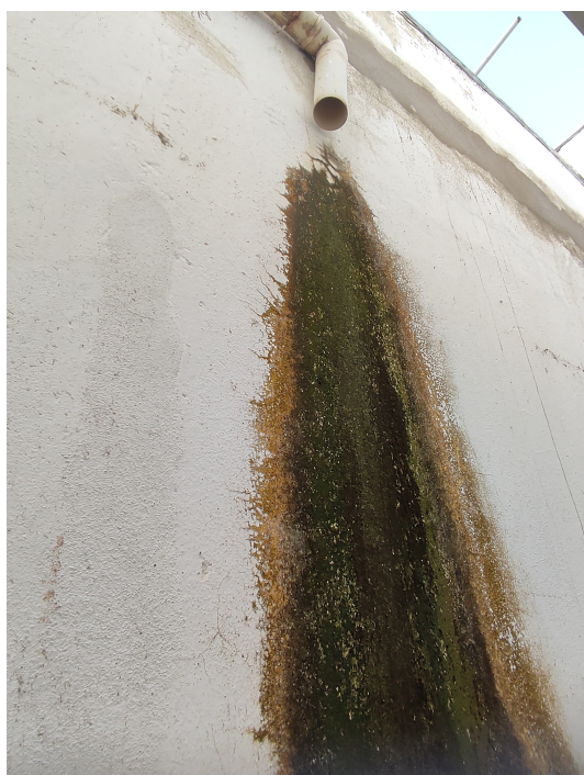
Figura 4.18 – Descarga d'água e bolor na fachada lateral esquerda.
