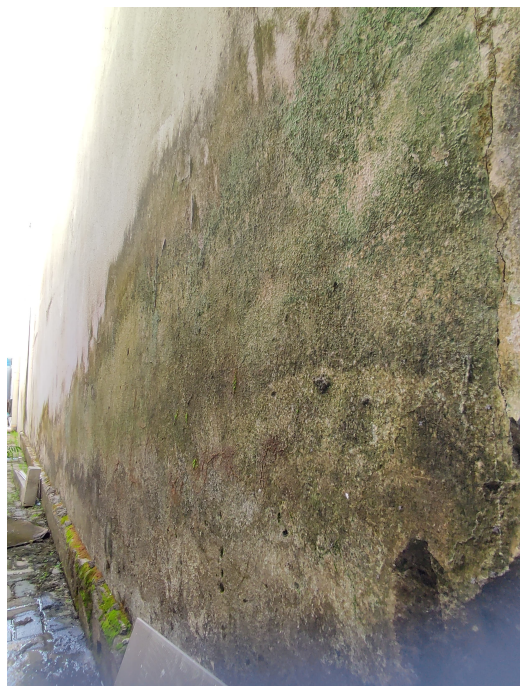
Figura 4.24 – Bolor generalizado no Reboco (fachada lateral esquerda).
