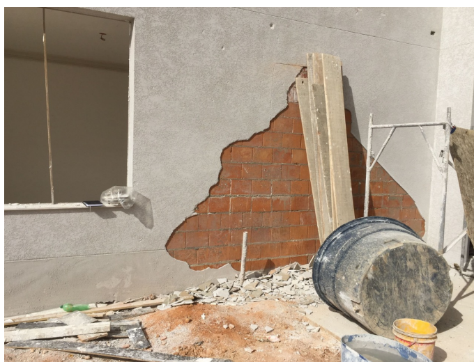
Figura 2.3 – Desplacamento de argamassa projetada em alvenaria.
