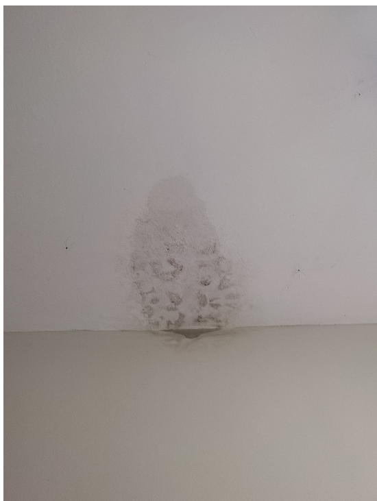
Figura 4.14 – Manchas na Laje da Galeria de Fotos.
