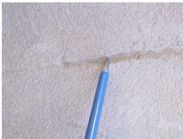
Figura 2.6 – Pulverulência em revestimento argamassado.
