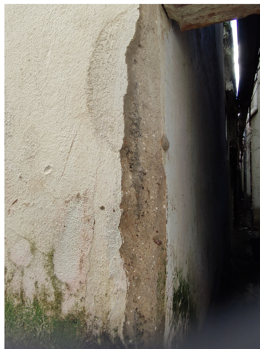
Figura 4.21 – Destacamento do reboco em quina de pilar.
