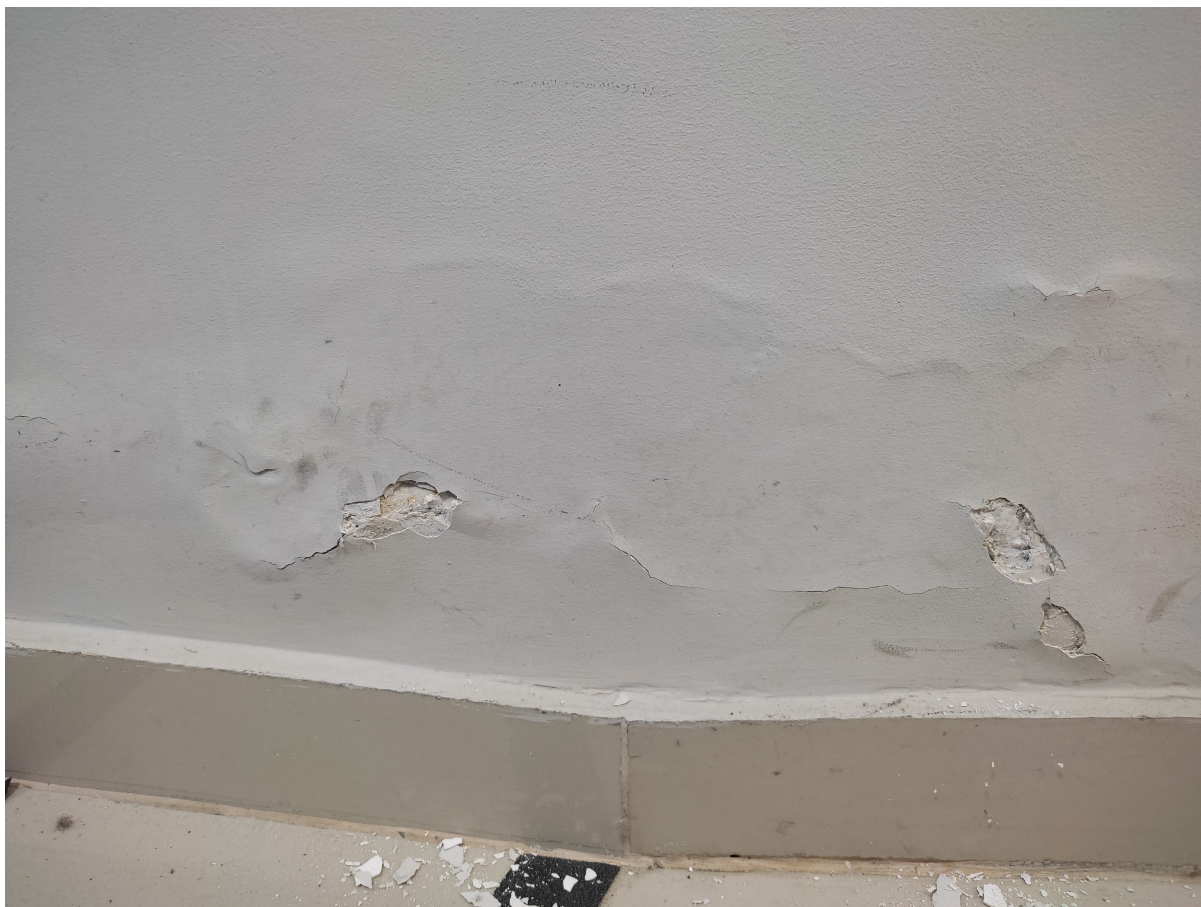
Figura 4.1 – Eflorescência e empolamento da pintura.
