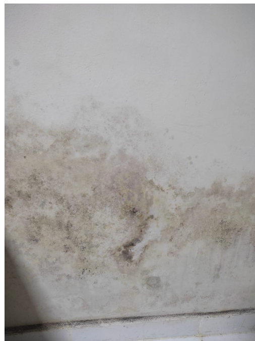
Figura 4.9 – Mofo e manchas no almozarifado.
