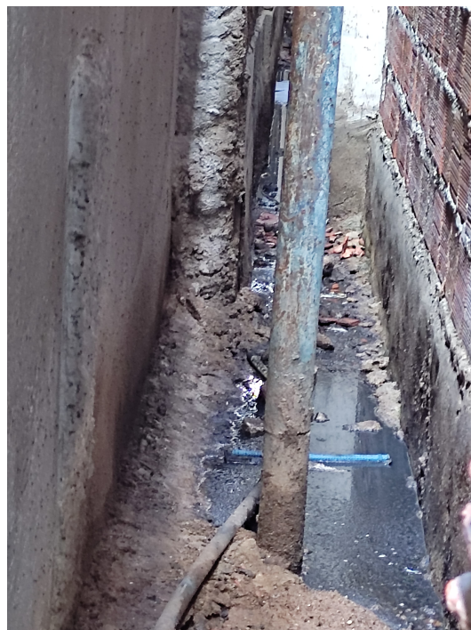
Figura 4.25 – Acumulo de água e esgoto na fachada posterior.
