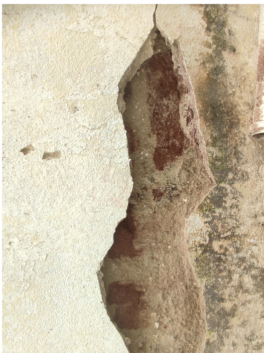
Figura 4.20 – Destacamento do reboco expondo alvenaria.
