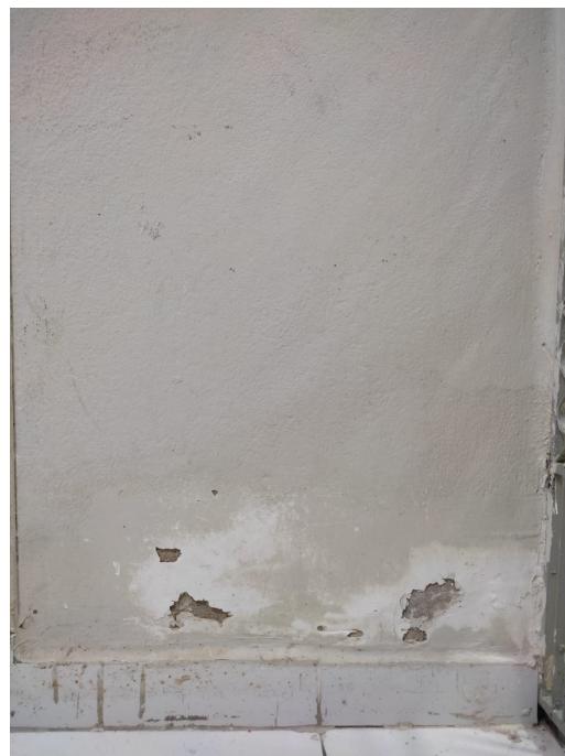
Figura 4.3 – Eflorescência no reboco da parede da copa.
