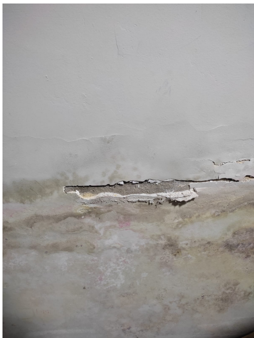
Figura 4.8 – Mofo e manchas no almozarifado.
