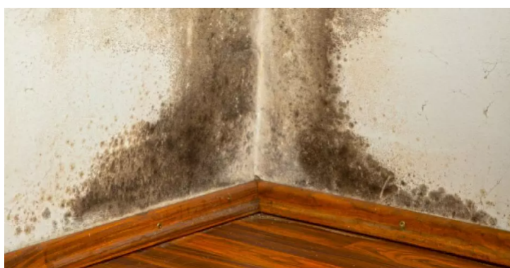
Figura 2.4 – Mofo em revestimento argamassado.
