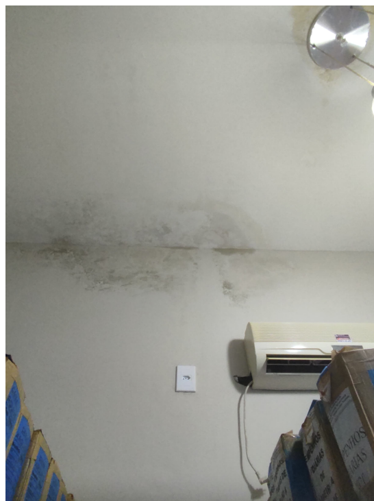
Figura 4.11 – Manchas e mofo na Sala de Arquivos.
