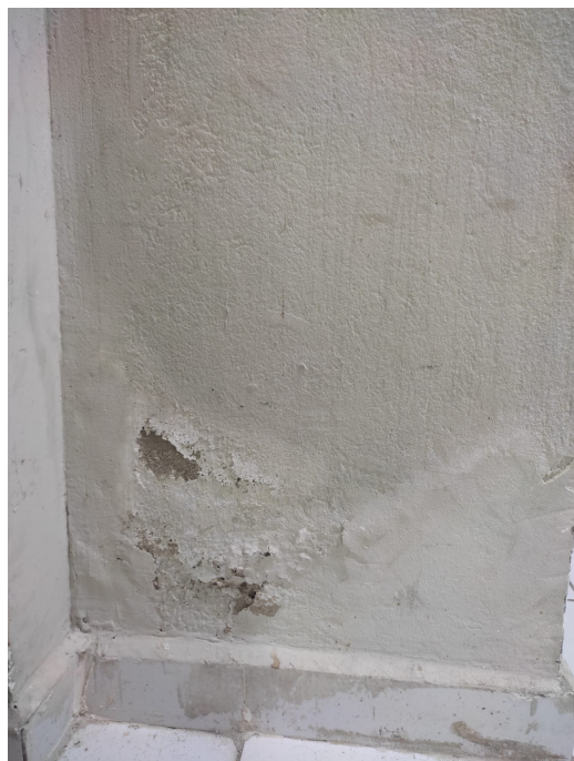
Figura 4.2 – Eflorescência no reboco da área de serviço.
