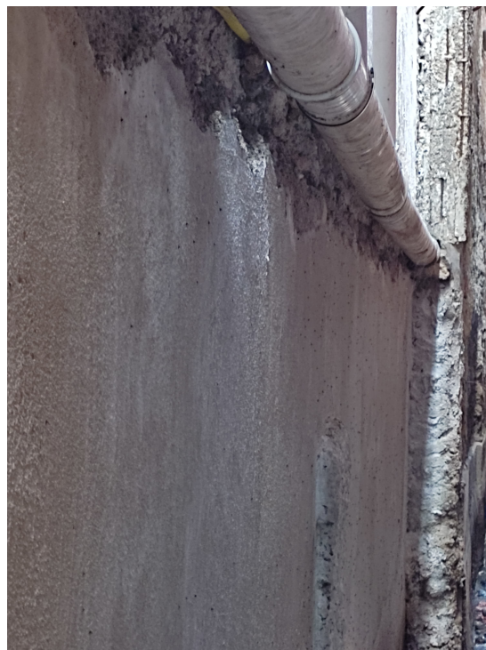
Figura 4.23 – Emboço descontínuo (fachada posterior).
