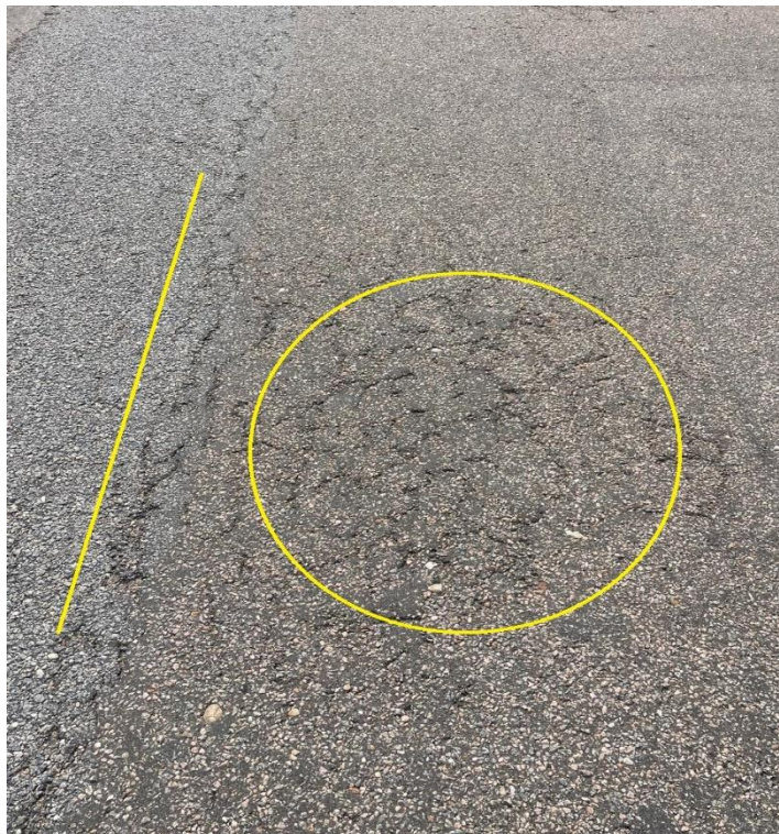
Figura 19 - Trincas Longitudinais e Couro de Jacaré
