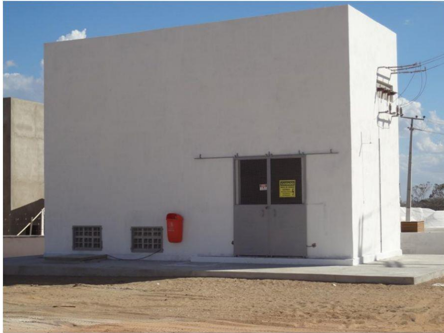
Figura 2 – Foto da Subestação
